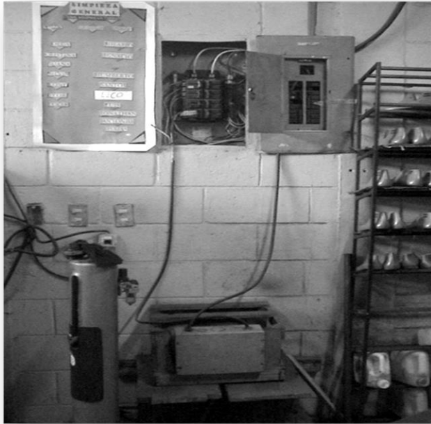
Figura 22. Estado cajas de circuitos, Fábrica de Calzado Ferreti S.A.
