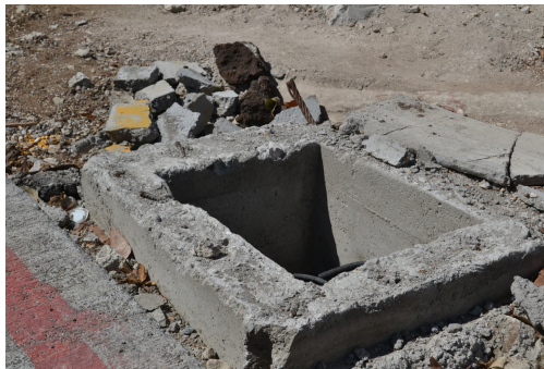
Figura 51. Acceso a drenajes
