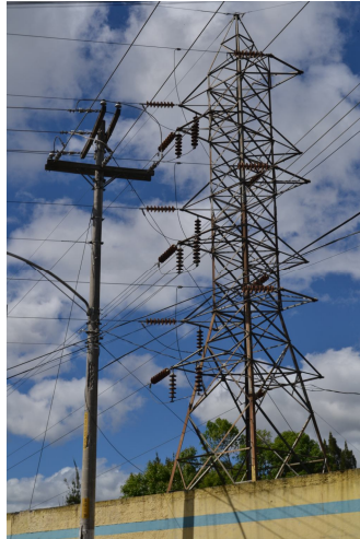
Figura 53. Acceso a fluido eléctrico
