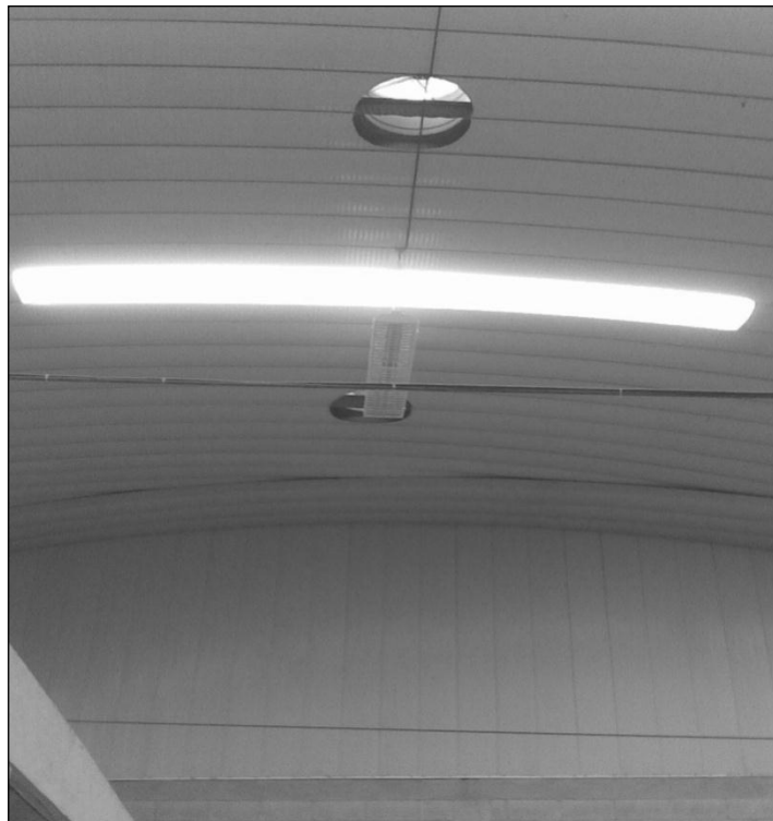
Figura 7. Iluminación en almacén CBSA
