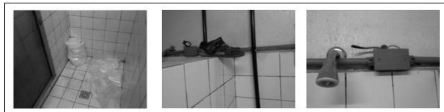
Figura 10. Riesgos identificados en servicios sanitarios
