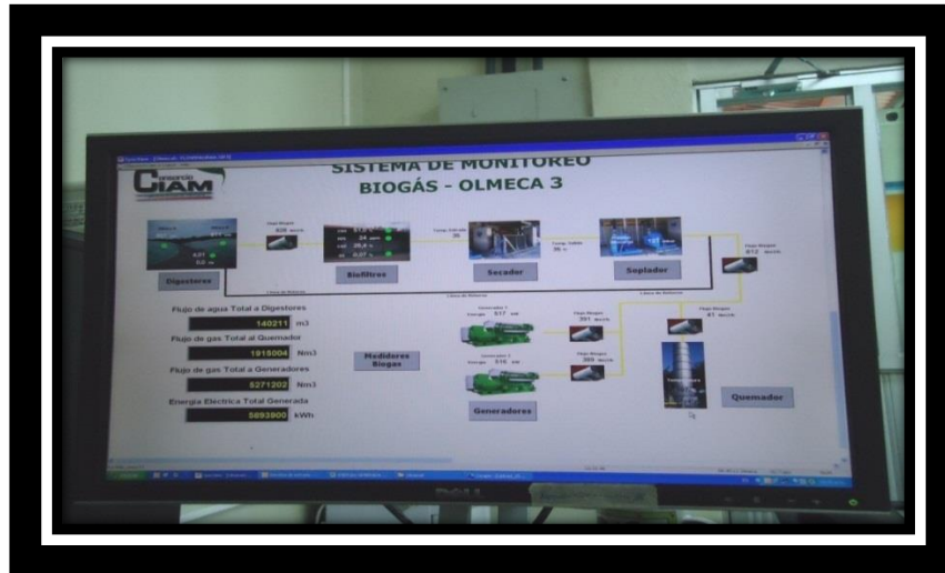
Figura 18. Sistema de monitoreo de biogás
