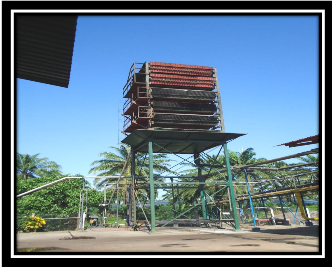
Figura 15. Torre de enfriamiento de agua
