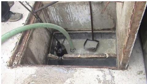
Figura 14. Sistema recolector de grasas de restaurante La Delica
