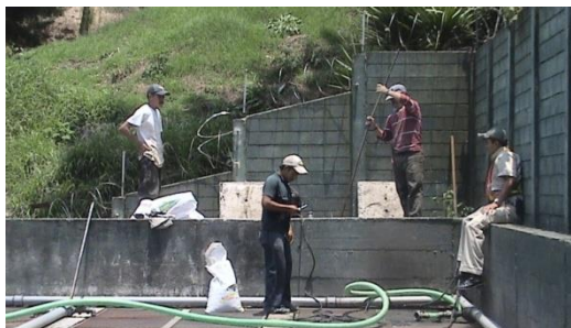
Figura 15. Planta de tratamiento de la empresa Desarrollos Inmobiliarios Pradera Concepción
