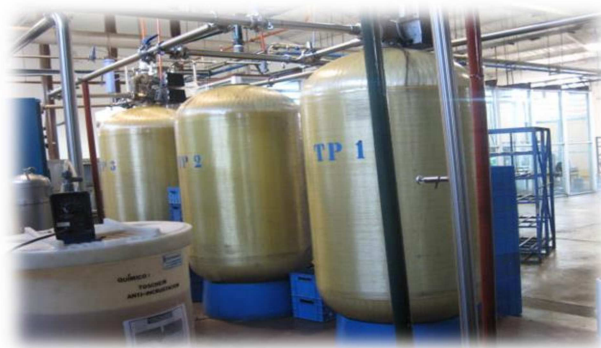
Figura 17. Filtro de arena
