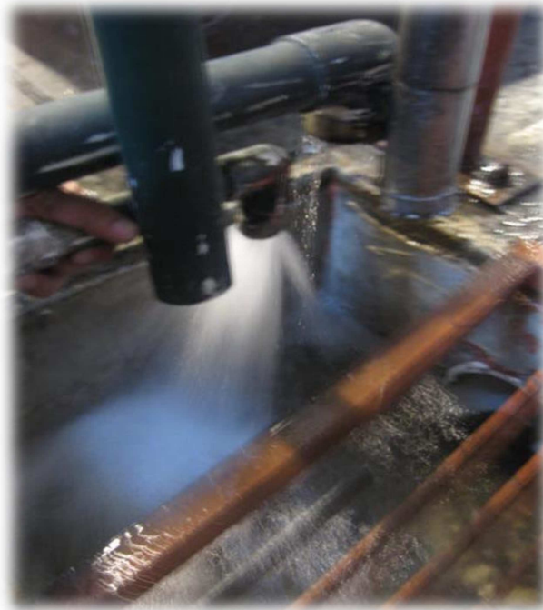
Figura 47. Salida de residuo de proceso de ósmosis inversa
