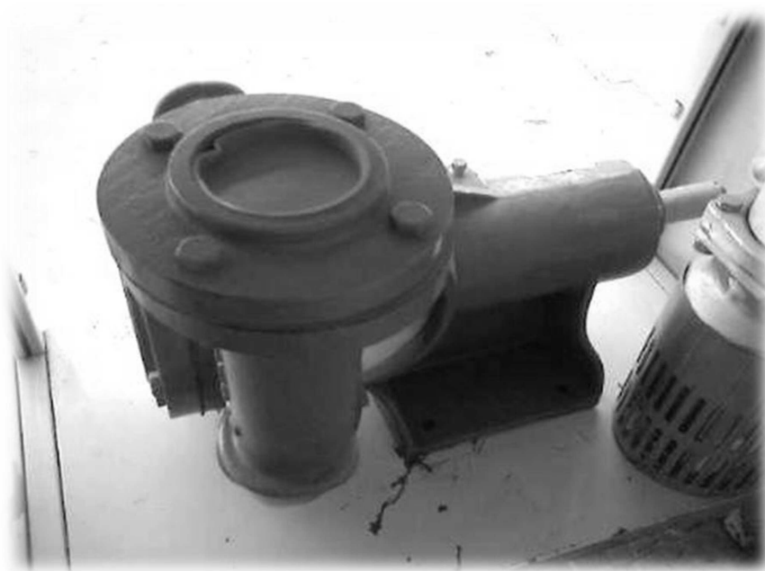
Figura 27. Bomba en pozo de extracción para servicios
