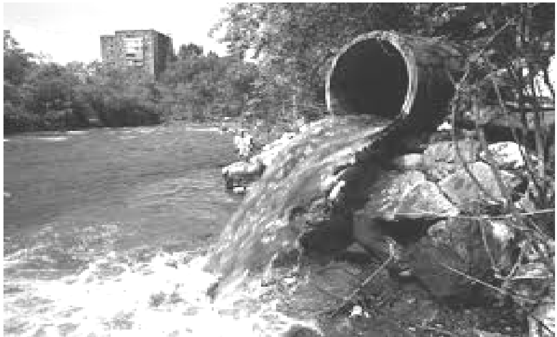
Figura 9. Desagües de aguas negras
