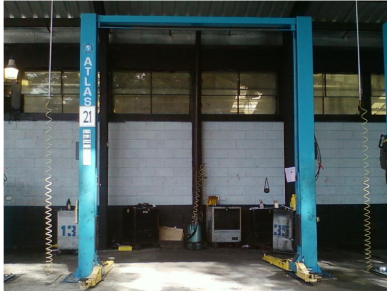
Figura 5. Puesto de trabajo (puente)
