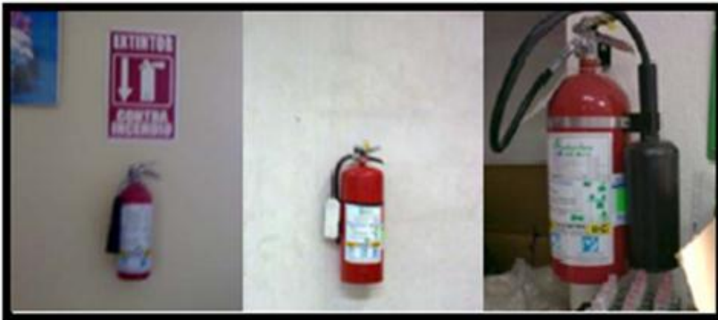
Figura 18. Uso de extintores
