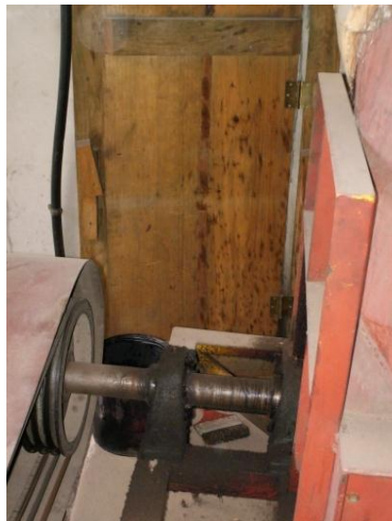
Figura 40. Puerta de inspección Área de Secado
