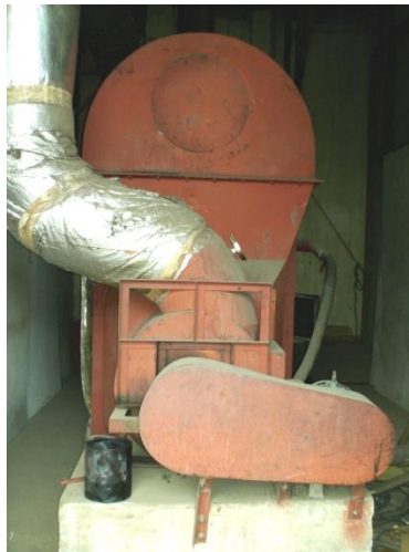
Figura 19. Horno conductor de calor
