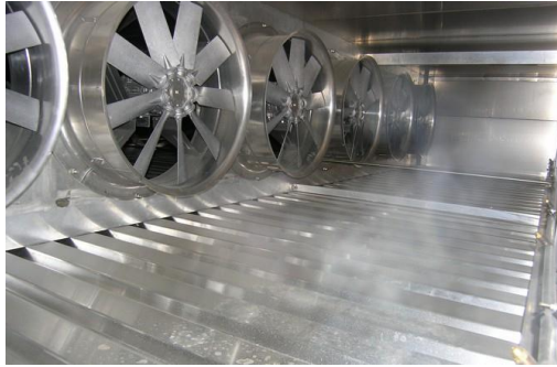
Figura 20. Ventiladores y deflectores de aire
