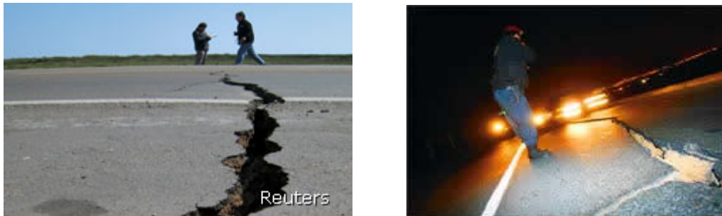
Figura 29. Grietas en red vial causadas por fenómeno sísmico
