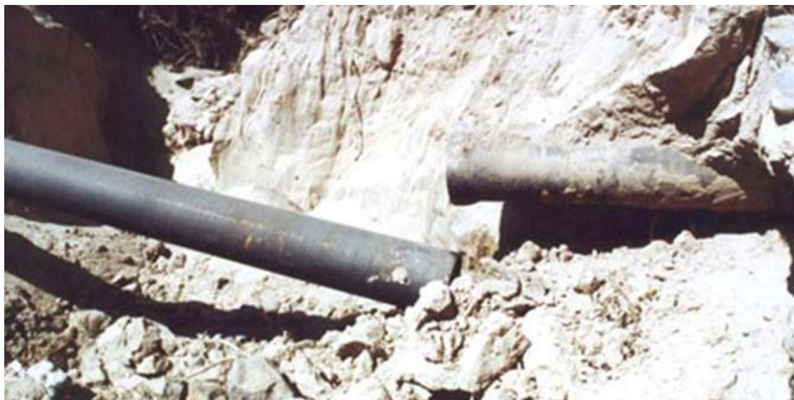
Figura 25. Rotura de tubería por derrumbes.
