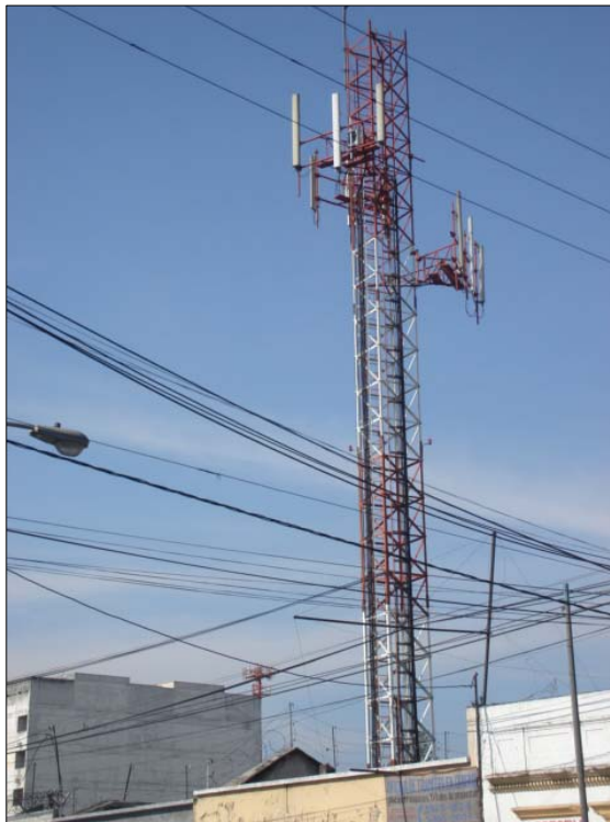
Figura 10. Torre de telefonía
