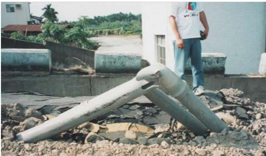
Figura 27. Daños en componentes difíciles de inspección, tuberías del circuito.
