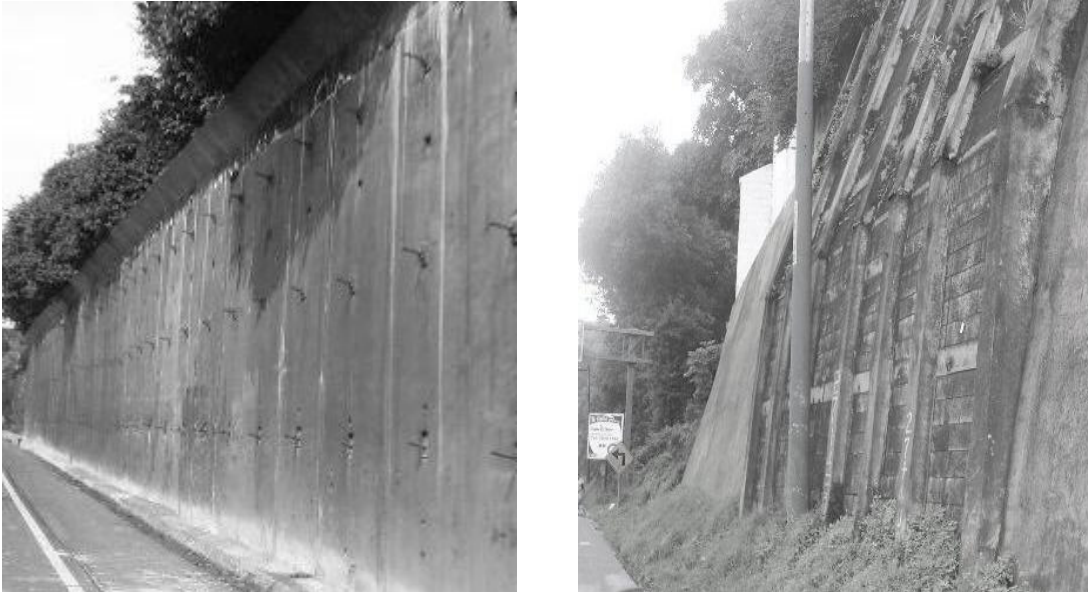
Figura 3. Variaciones en la construcción de muros de concreto armado. A la izquierda un muro en tipo “L” al que le colocaron anclajes metálicos. A la derecha muro de mampostería y concreto armado con contrafuertes.
