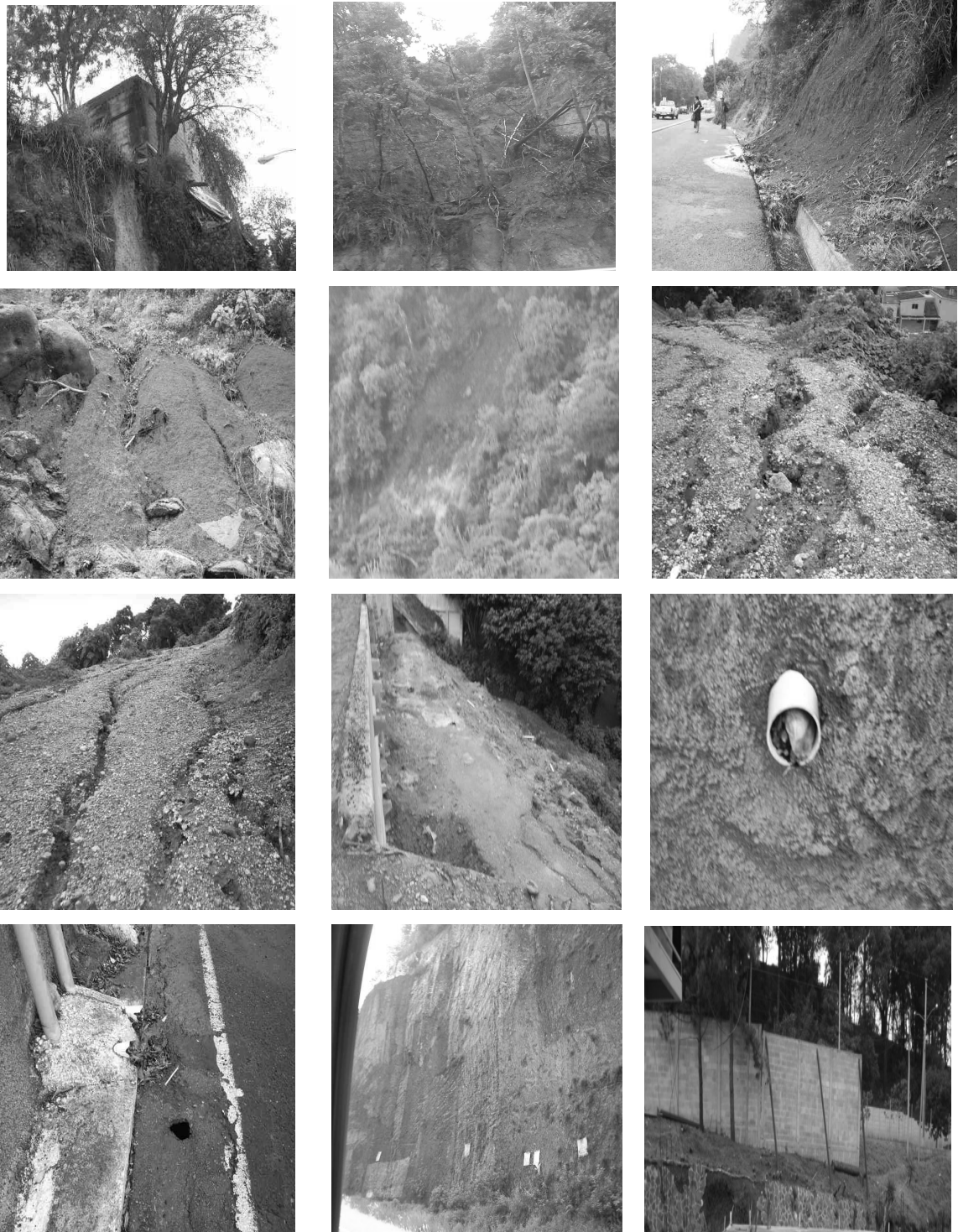
Fuente: Taludes y laderas ubicados en la Ciudad de Guatemala y sus colindancias.
