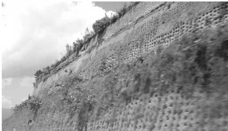
Figura 38. Talud recubierto con vegetación de manera deficiente.
