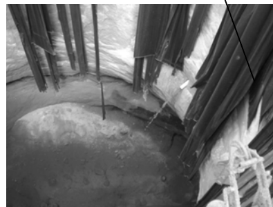
Caída del Relleno fluido
