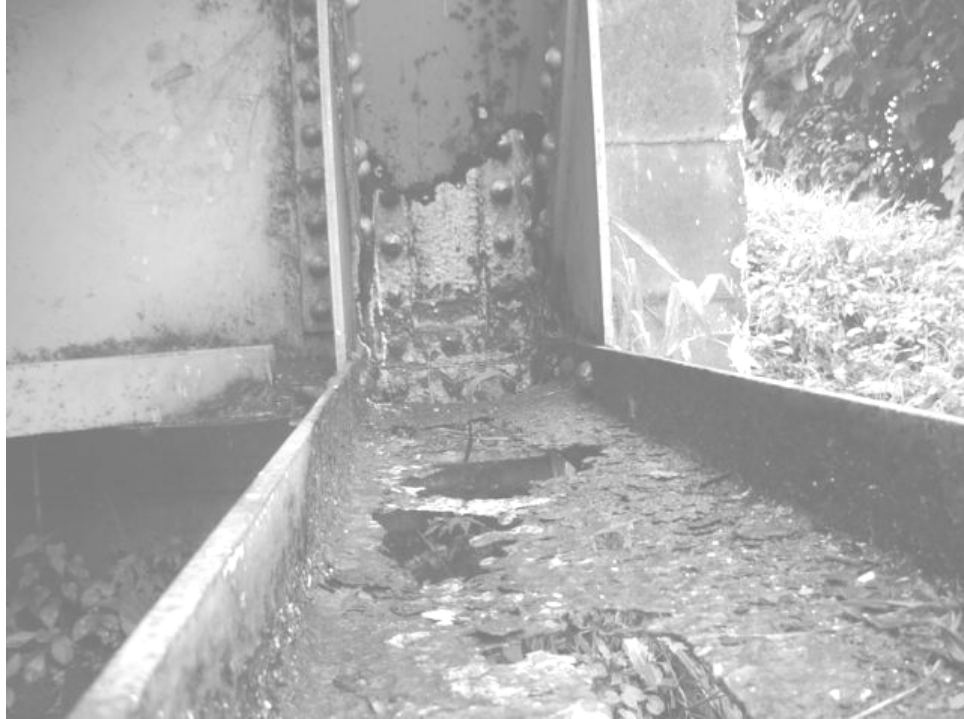
Figura 36. Picadura de una estructura de puente
