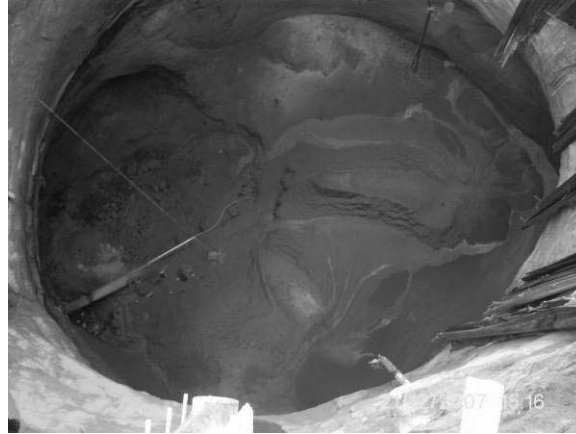
Hundimiento de Barrio San Antonio zona 6, de 64 metros de profundidad.
