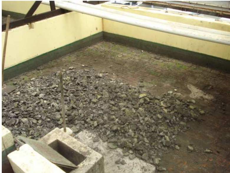
Figura 20: Patio de secado de lodos de la planta de tratamiento San Antonio
