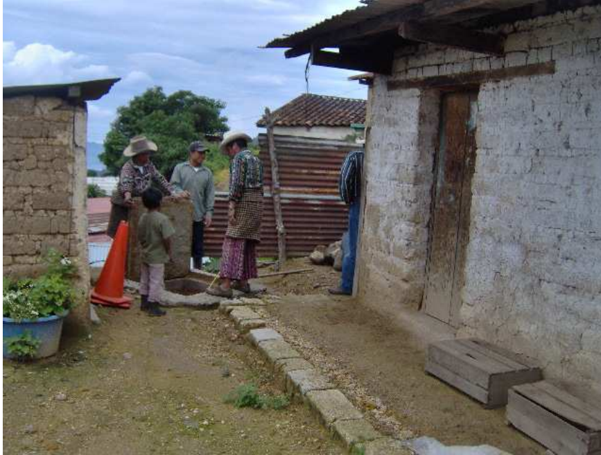
Figura 38: Caja de visita ubicada en casa particular
