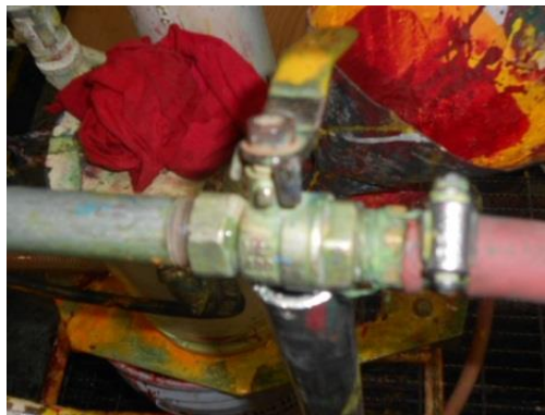
Figura 28. Válvula de bola instalada en conversión
