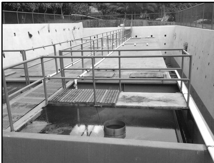
Figura 45. Tanques de tratamiento
