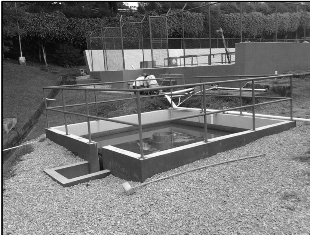
Figura 43. Planta de tratamiento de agua
