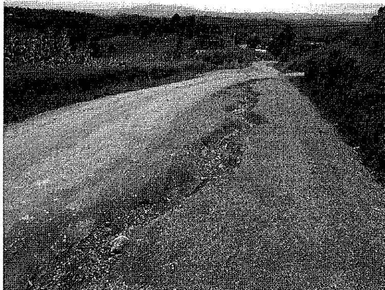
Figura 19. Erosión y pérdida de la sección típica
