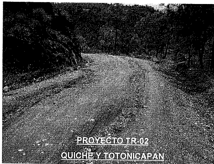
Figura 18. Condiciones iniciales del tramo carretero
