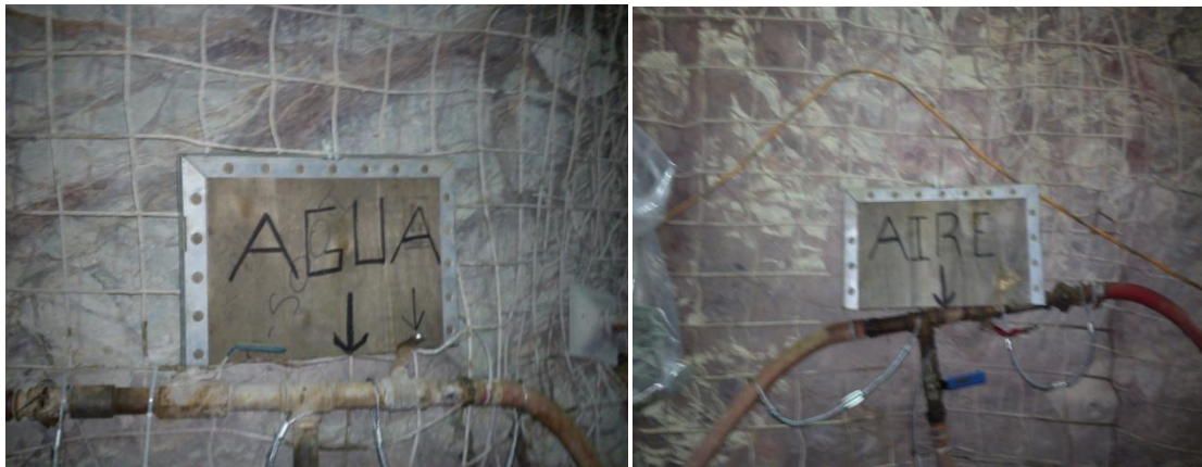
Figura 15. Señalización inadecuada y poco visible en stope 1, mina subterránea
