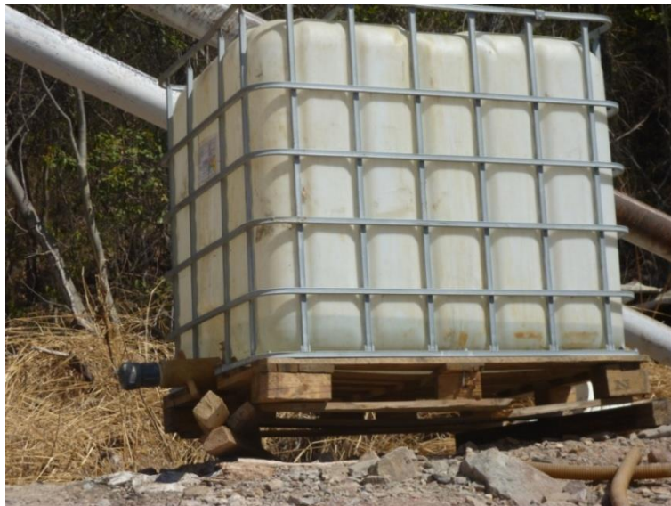
Figura 13. Objeto instalado o colocado de forma inadecuada
