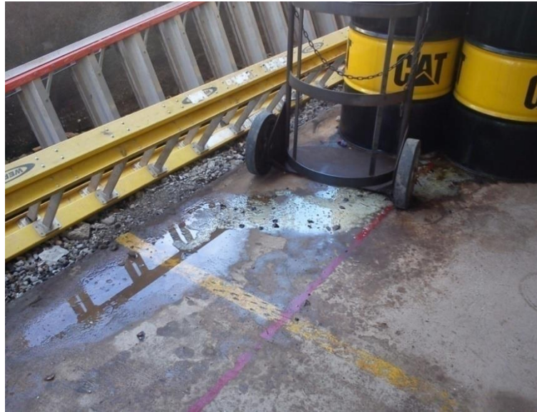
Figura 7. Área de generación, derrame de aceite
