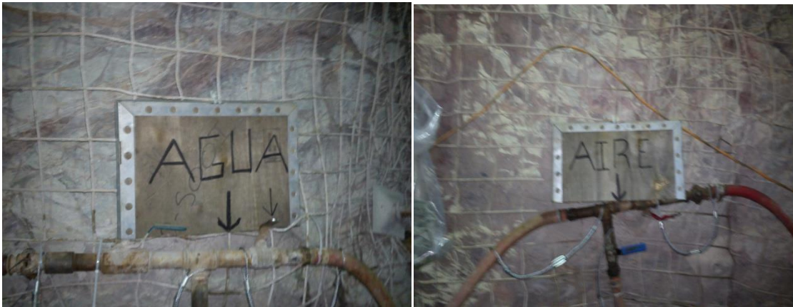
Figura 21. Señalización inadecuada y poco visible en stope 1, mina subterránea
