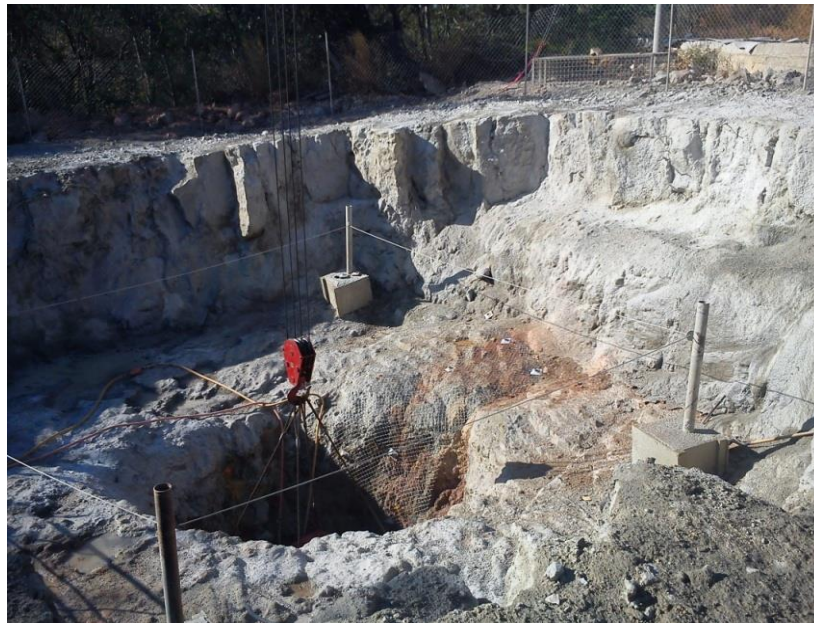
Figura 14. Área de trabajo sin ninguna señalización (chimenea sur)
