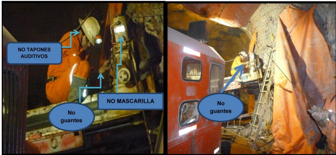
Figura 19. Deficiencias por falta de EPP (dentro de túnel, área de perforación, stope 1)
