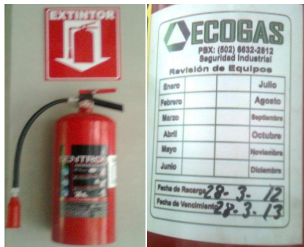
Figura 26. Extintor de área administrativa
