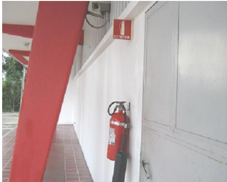
Figura 46. Fotografía de equipos contra incendio instalados
