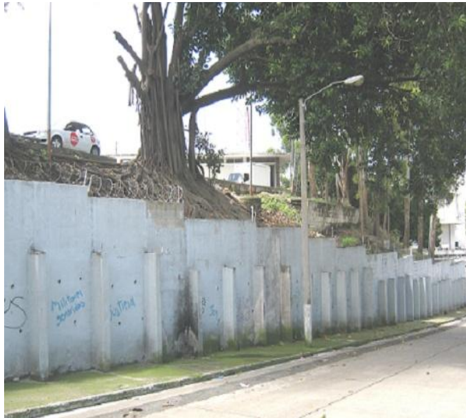
Figura 42. Fotografía de zona de riesgo 1 ladera
