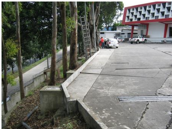
Figura 43. Fotografía zona de riesgo 1 ladera vista del parqueo
