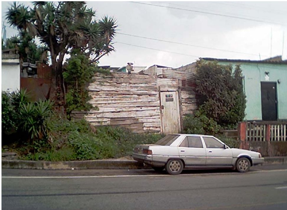
Figura 40 Ejemplo de los problemas típicos observados en estructuras de madera.
