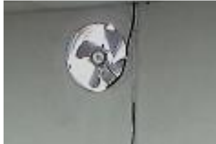
Figura 24. Extractores de aire
