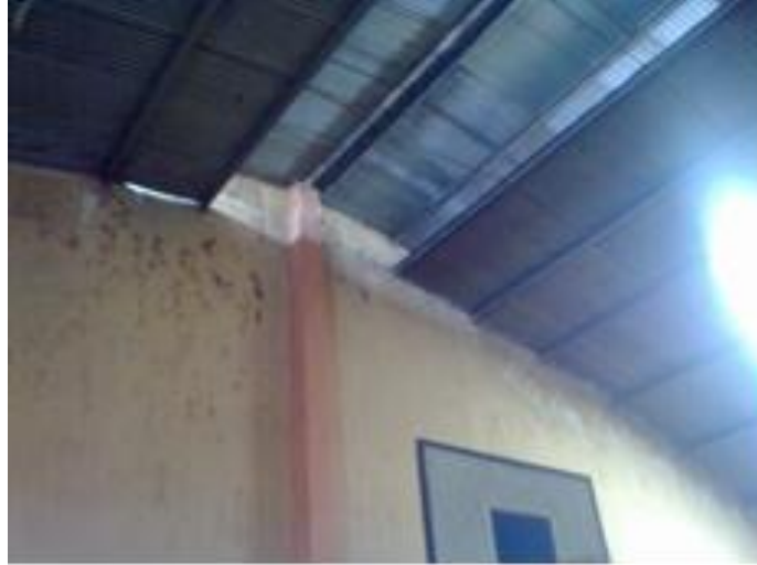
Figura 33. Estado de las paredes del salón
