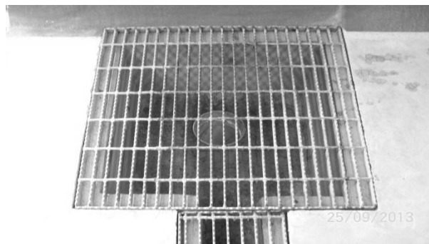
Figura 24. Caja recolectora de agua servida
