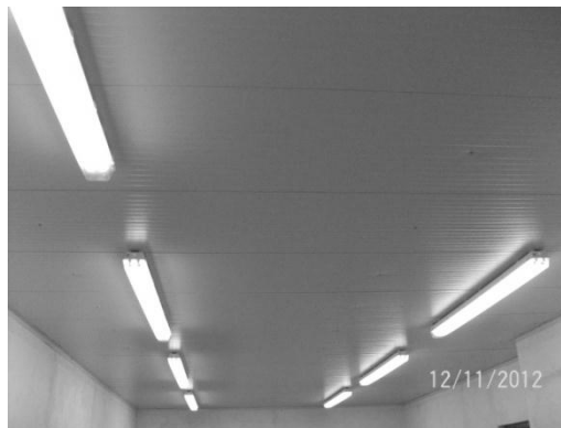
Figura 6. Iluminación del área de proceso
