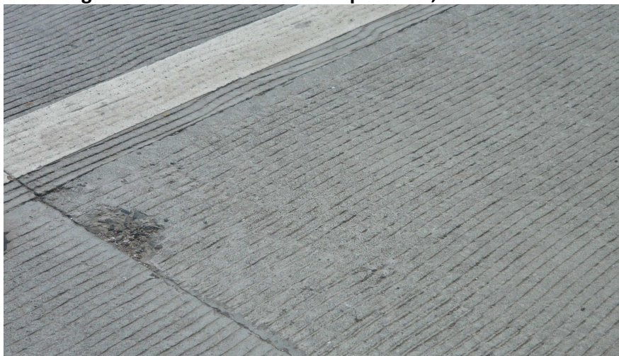
Figura 62. Descascaramiento o peladura, RN-10 km. 30
