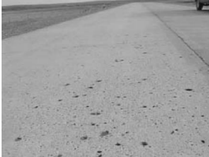
Figura 10. Desintegración de pavimento rígido baja
