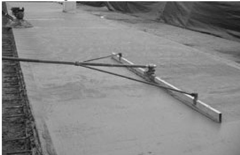
Figura 36. Exudación de concreto
