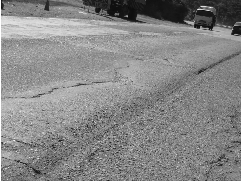
Figura 42. Fallas por fisuras longitudinales, carretera CA-09 Norte km. 37
