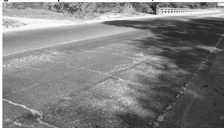
Figura 47. Falla por fisuras transversales, CA-09 Norte km. 46
