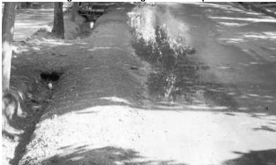
Figura 7. Erosión longitudinal de carpeta
