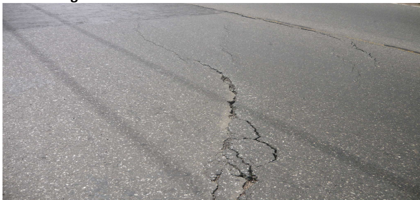
Figura 81. Hundimiento San Cristóbal Villalobos
