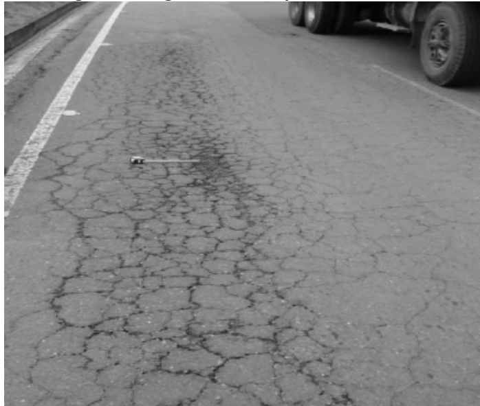
Figura 22. Agrietamiento piel de cocodrilo
