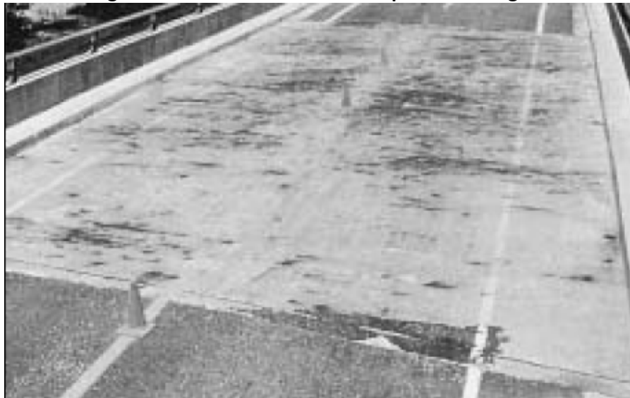
Figura 37. Corrosión de acero en pavimento rígido
