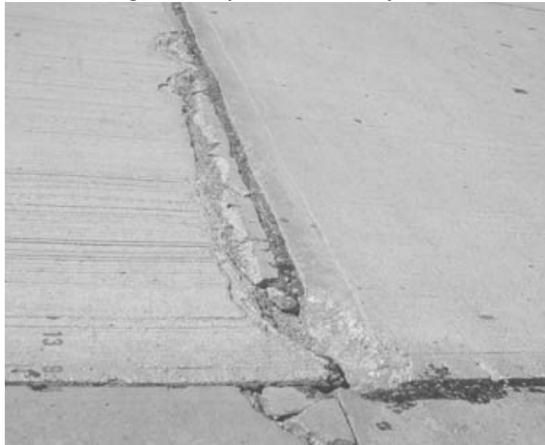
Figura 8. Despostillamiento de juntas
