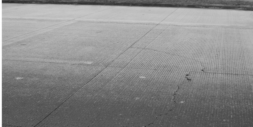
Figura 69. Agrietamiento de esquina y fisura transversal, CA-02 km. 41.7
