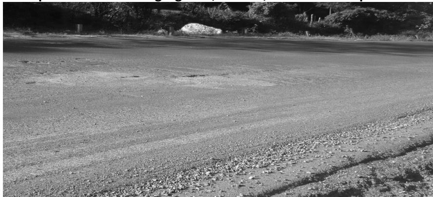
Figura 53. Desprendimiento de agregados, baches, fisuras en bloque CA-09 Sur km. 41
