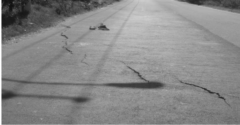
Figura 79. Hundimiento Tramo San Cristóbal Villalobos
