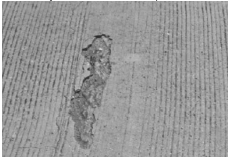
Figura 9. Descascamiento o peladura
