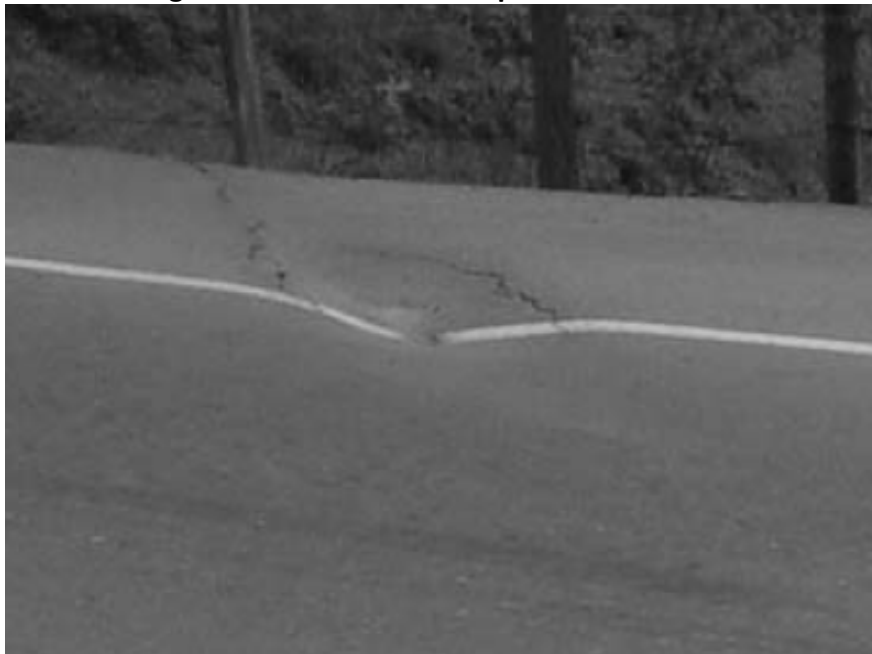
Figura 16. Hundimiento en pavimento flexible
