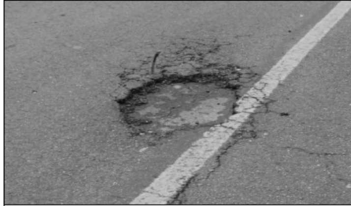
Figura 1. Descascamiento o peladura
