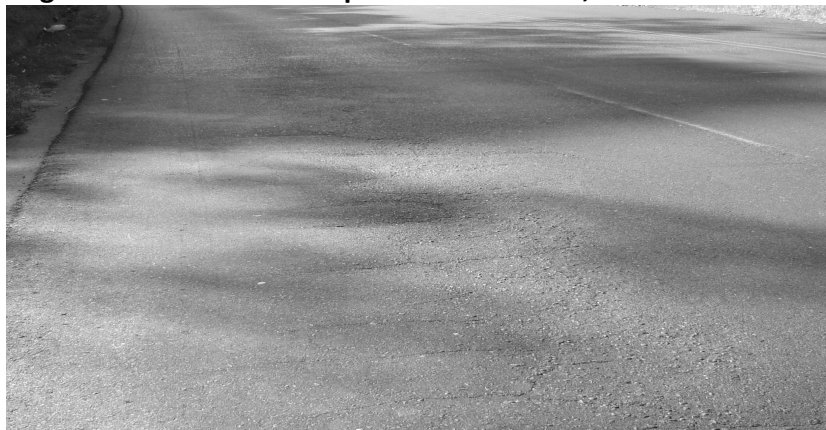
Figura 57. Corrimiento superficial de asfalto, CA-09 Sur km. 45
