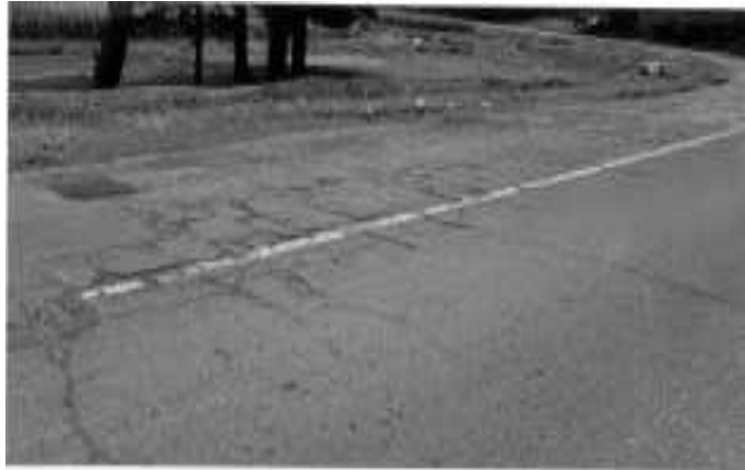
Figura 23. Fisuras en bloque
