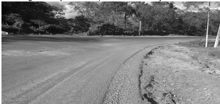
Figura 54. Desintegración carpeta asfáltica, descascaramientos y baches CA-09 Sur km. 41
