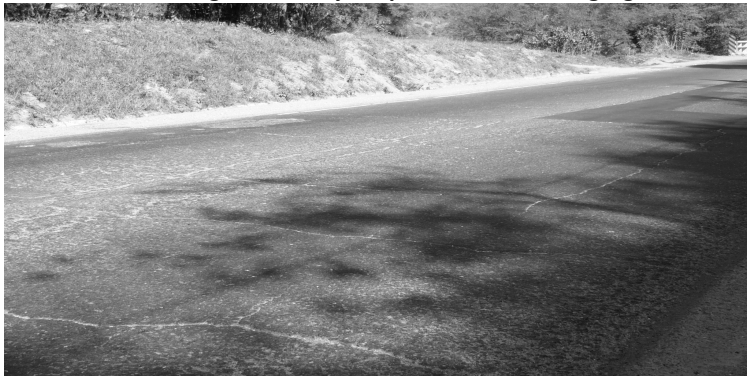
Figura 50. Grietas transversales, longitudinales y desprendimiento de agregados CA-09 Norte km. 46
