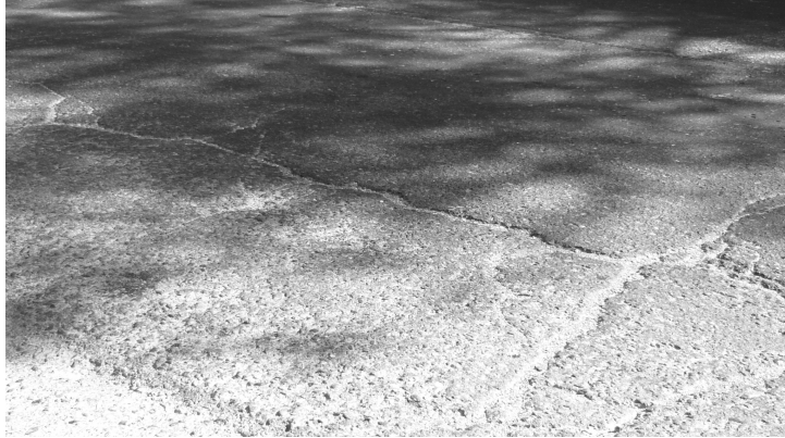
Figura 48. Falla por grietas longitudinales, CA-09 Norte km. 46
