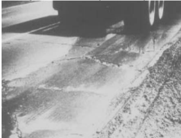
Figura 38. Bombeo o eyección en la junta
