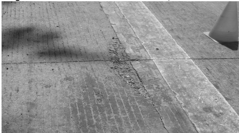
Figura 65. Descascaramiento o Peladura, RN-10 km. 32.8
