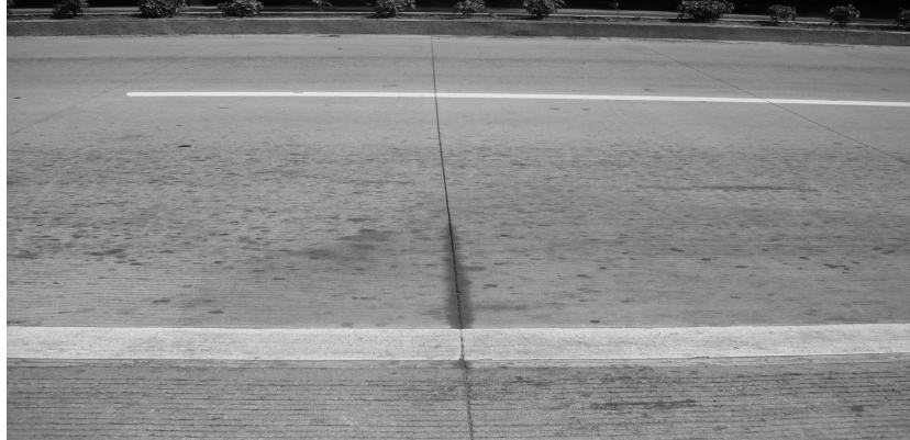
Figura 67. Bombeo o eyección de junta, RN-10 km. 32.8
