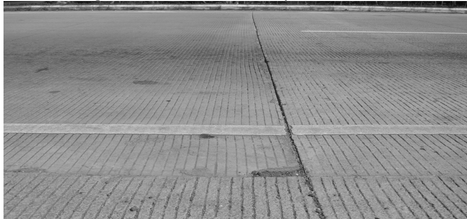
Figura 77. Descascaramiento o peladura, km.44
