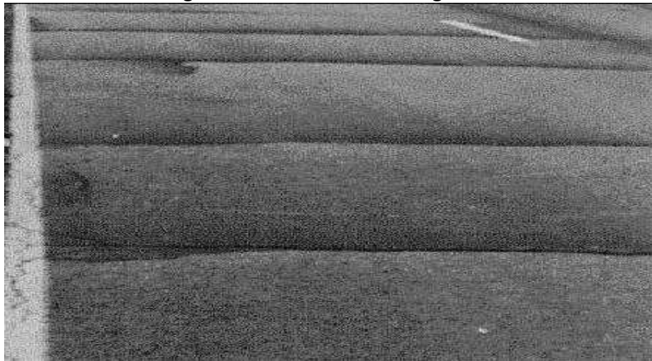
Figura 15. Ondulación o corrugación
