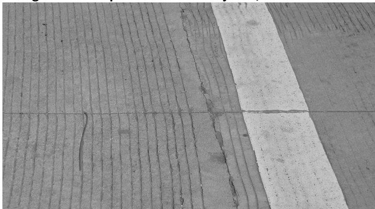
Figura 66. Despostillamiento de junta, RN-10 km. 32.8
