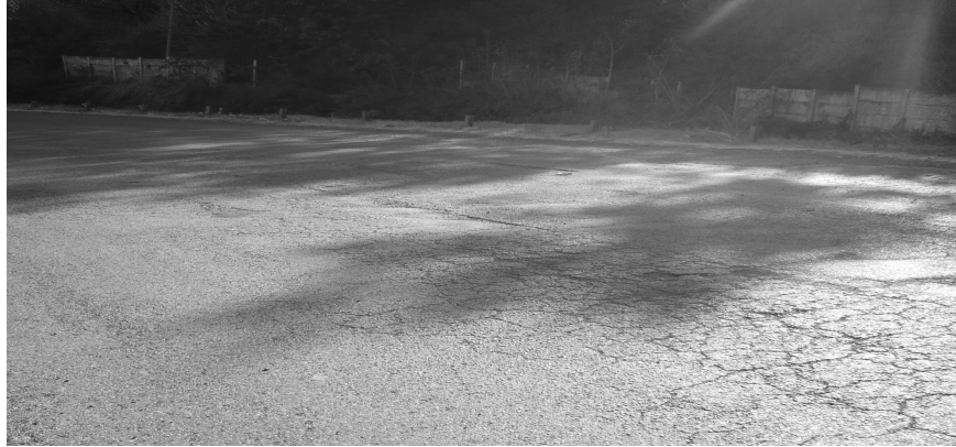
Figura 52. Agrietamiento piel de cocodrilo, CA-09 Sur km. 41
