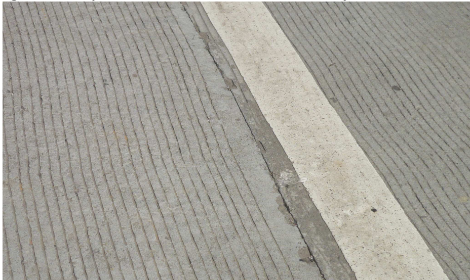
Figura 61. Despostillamiento o descascaramiento de junta, RN-10 km. 30
