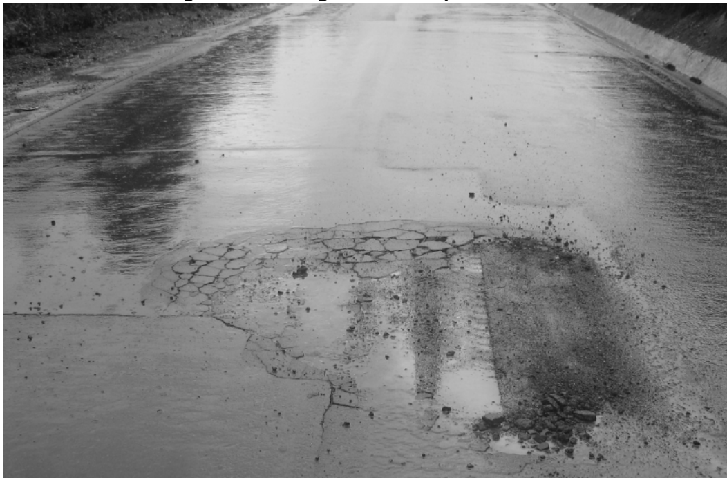
Figura 6. Desintegración de carpeta asfáltica
