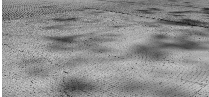
Figura 76. Fisura transversal y agrietamiento de esquina, CA-02 km.44
