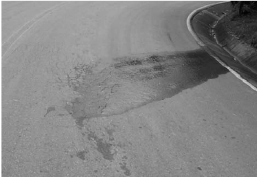
Figura 34. Afloramiento de agua sobre el pavimento
