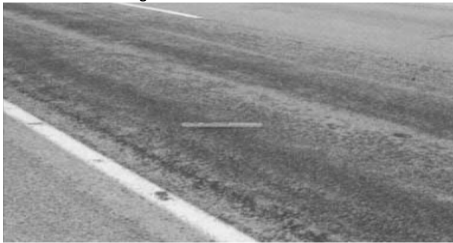
Figura 35. Exudación de asfalto
