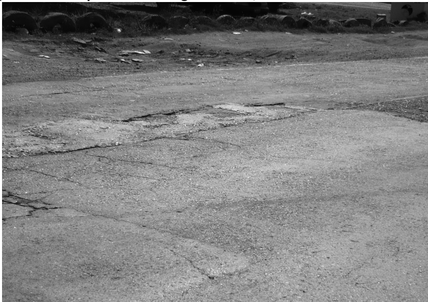
Figura 43. Falla por fisuras longitudinales, carretera CA-09 Norte km. 37
