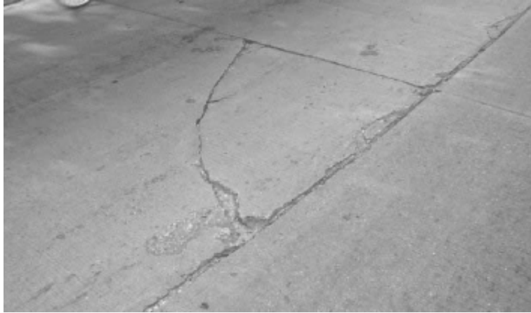
Figura 28. Agrietamiento de esquina
