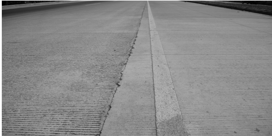
Figura 72. Descascaramiento o peladura y despostillamiento de juntas CA-02 km. 41.7
