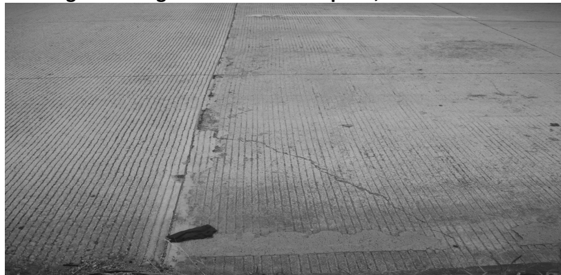
Figura 71. Agrietamiento de esquina, CA-02 km. 41.7
