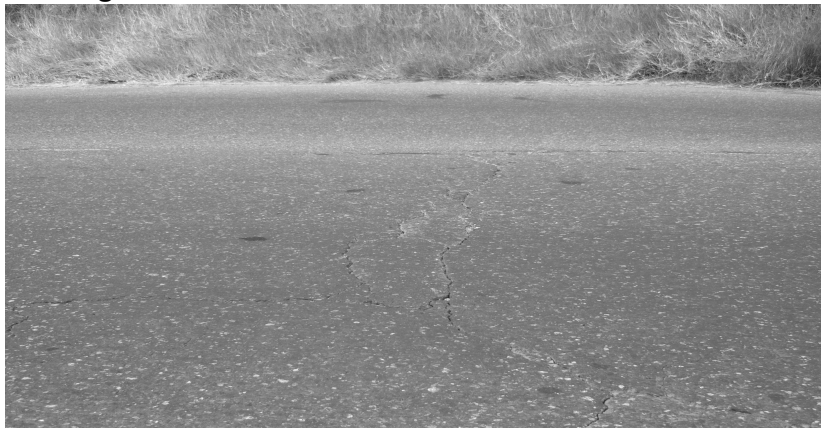
Figura 80. Grieta Transversal San Cristóbal Villalobos
