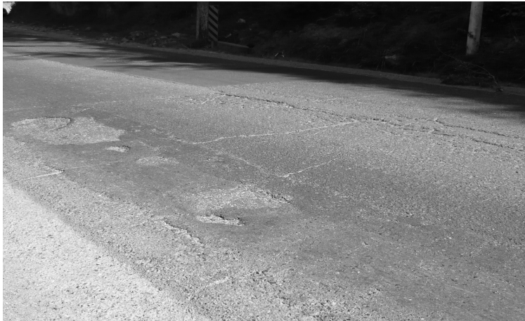
Figura 49. Falla por descascamiento, CA-09 Norte km. 46
