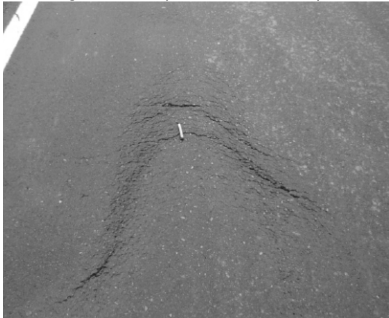
Figura 26. Fisura por deslizamiento de capas
