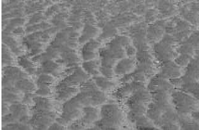
Figura 18. Corrimiento superficial de asfalto
