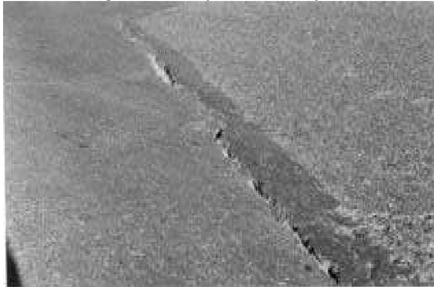
Figura 27. Fisura por reflexión de junta
