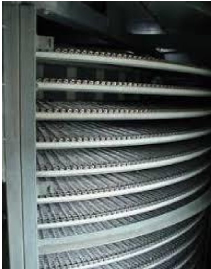
Figura 16. Banda helicoidal del túnel de congelado
