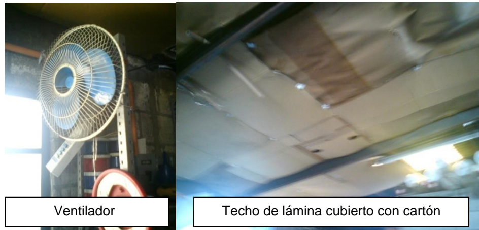
Figura 25. Ventilación no apropiada y techo en Departamento de Serigrafía
