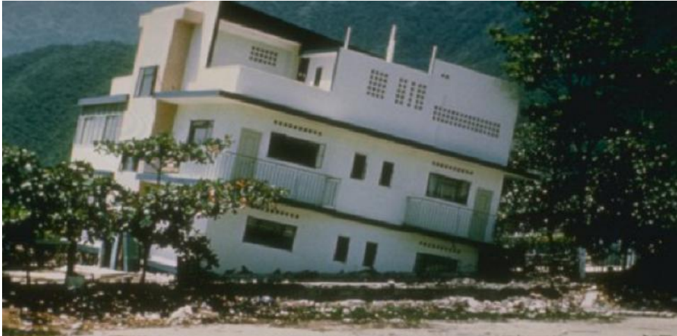
Figura 21. Hundimiento parcial de una casa
