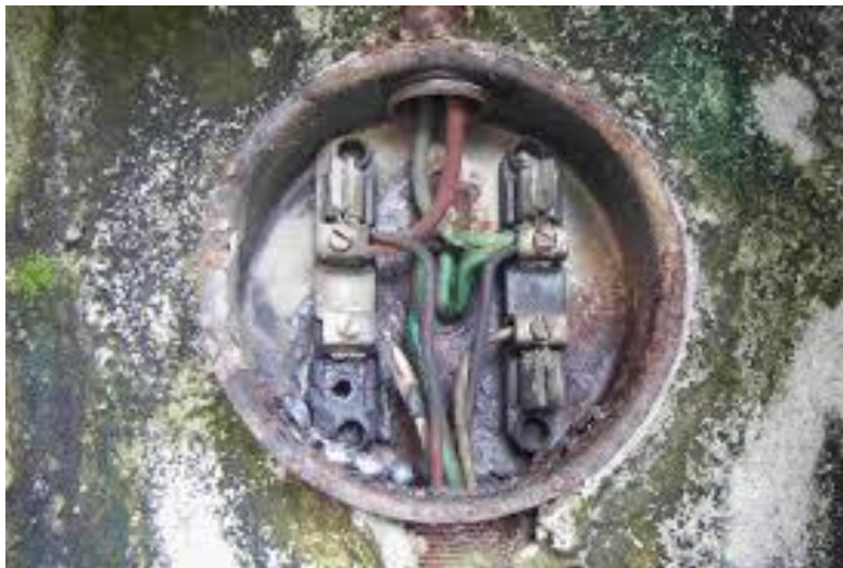
Figura 9. Deterioro de la caja tipo socket
