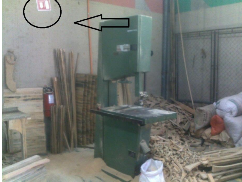
Figura 33. Extintores y su ubicación
