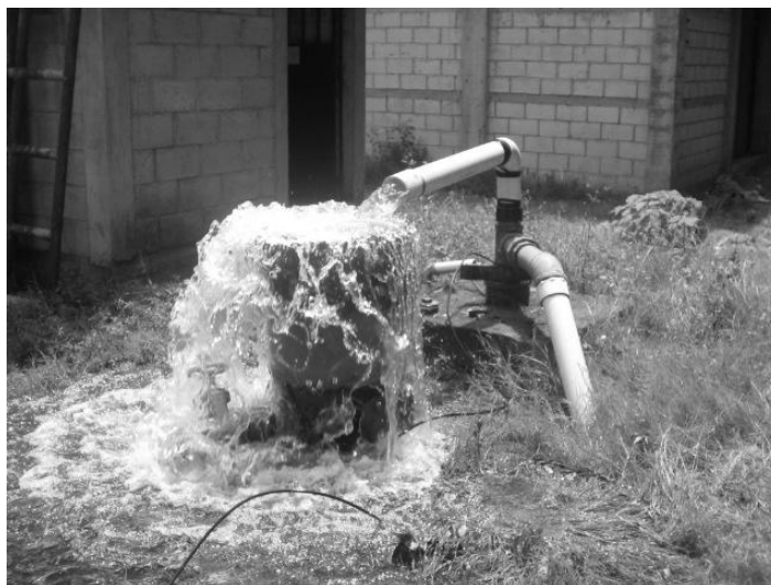
Figura 18. Bombeo continuo en pozo del CEDA
