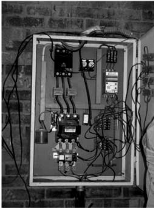
Figura 20. Panel de control pozo 1, Facultad de Ingeniería
