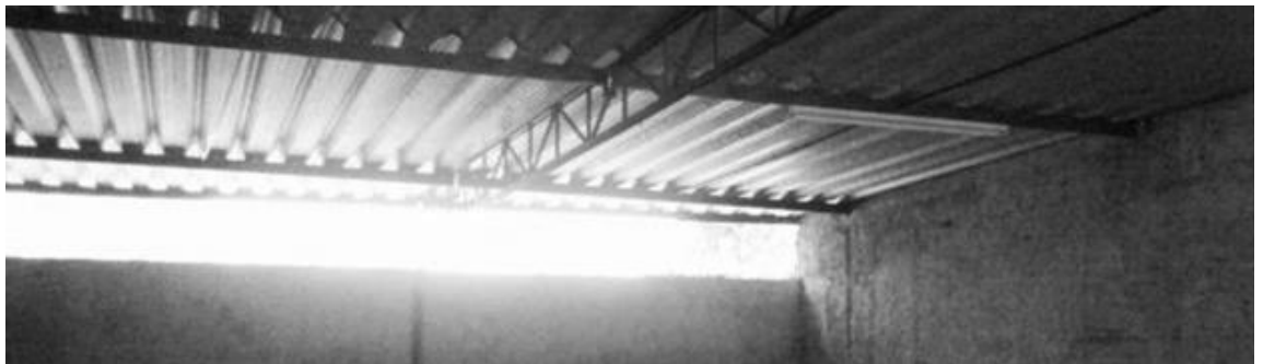
Figura 17. Ventilación natural de la bodega
