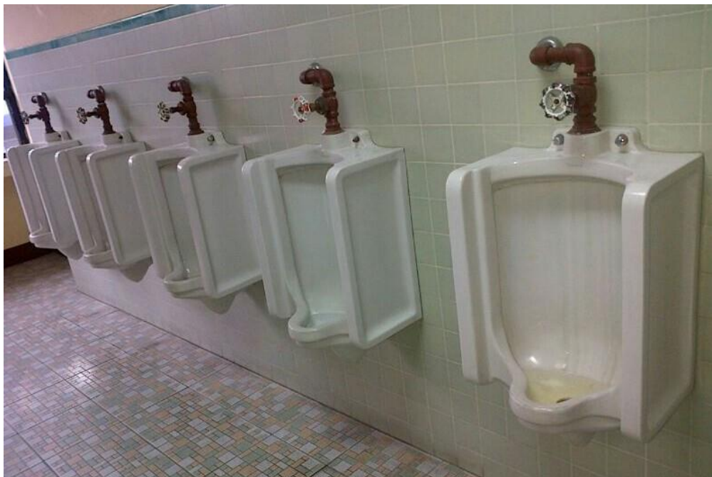
Figura 15. Mingitorios disponibles en el edificio T-3
