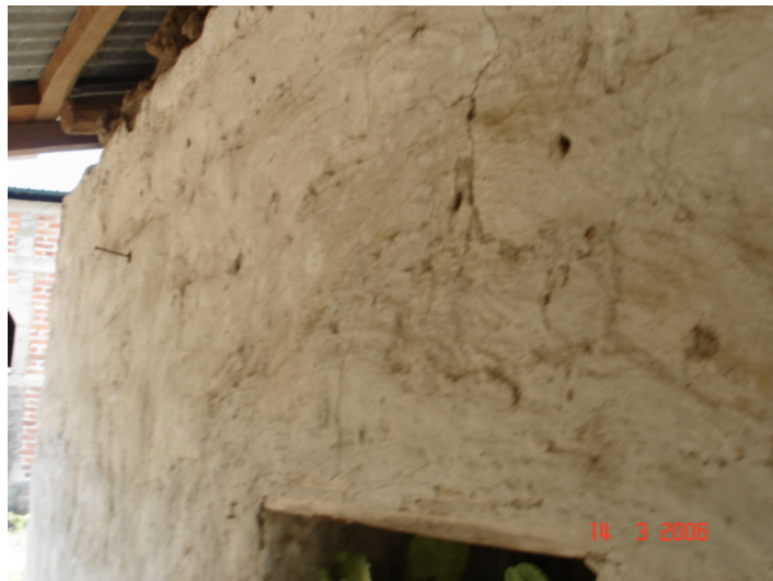
Figura 3. Condiciones de una vivienda de adobe en la aldea El Sillón, municipio de Yupiltepeque, departamento de Jutiapa, Guatemala.
