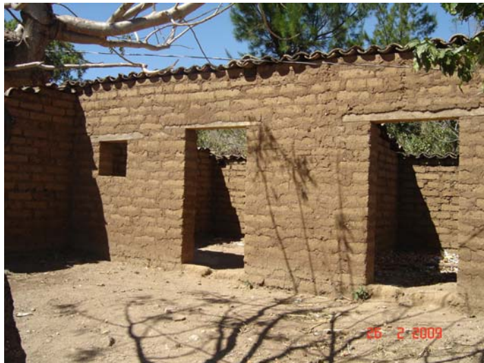
Figura 1. Construcción de una vivienda de adobe en la aldea La Brea, municipio de Quezada, departamento de Jutiapa, Guatemala.
