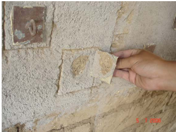
Figura 27. Revisión de falla de ensayo de arrancamiento (adherencia).
