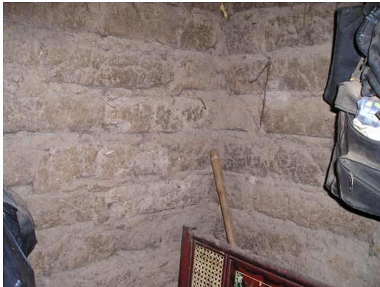
Figura 12. Interior de una vivienda de adobe en la aldea “El Sillón” municipio de Yupiltepeque, departamento de Jutiapa.
