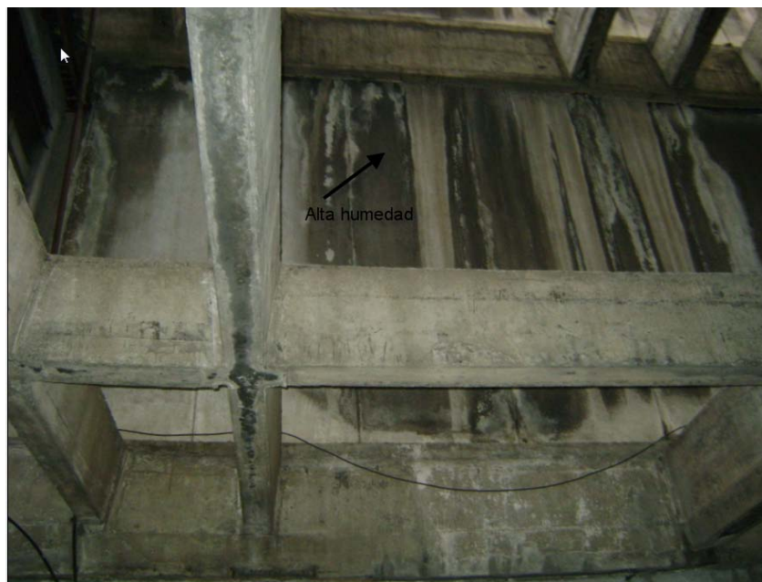
Figura 39. Fotografía de muro con alta humedad
