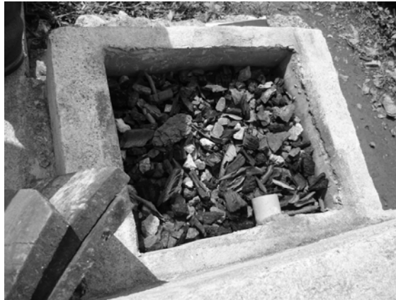
Figura 11. Filtro compuesto de arena, piedrín y piedra pómez
