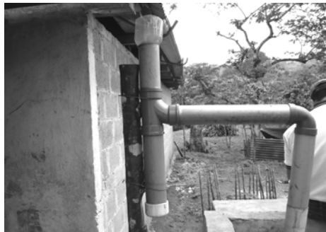
Figura 8. Sistema eliminador de primeras aguas
