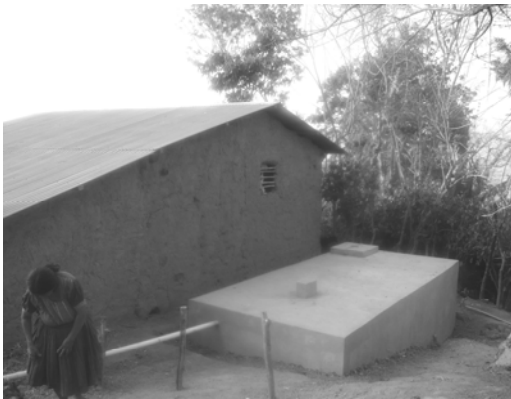
Figura 13. Aljibe de concreto armado ASORECH
