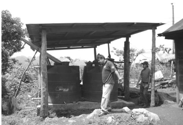
Figura 38. Aljibe individual de polietileno
