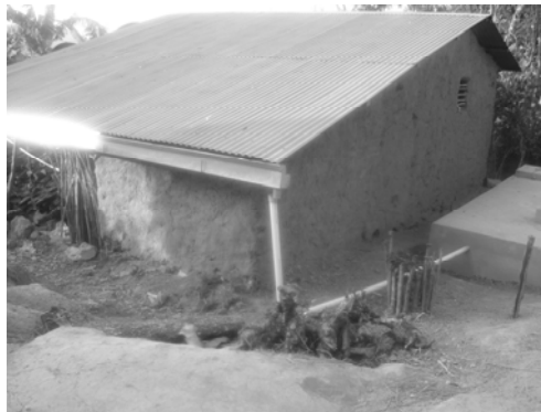
Figura 14. Lamina de zinc para captación de agua de lluvia
