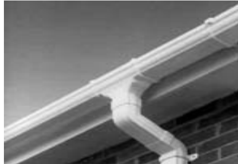
Figura 3. Canaleta de plástico para recolección de agua de lluvia
