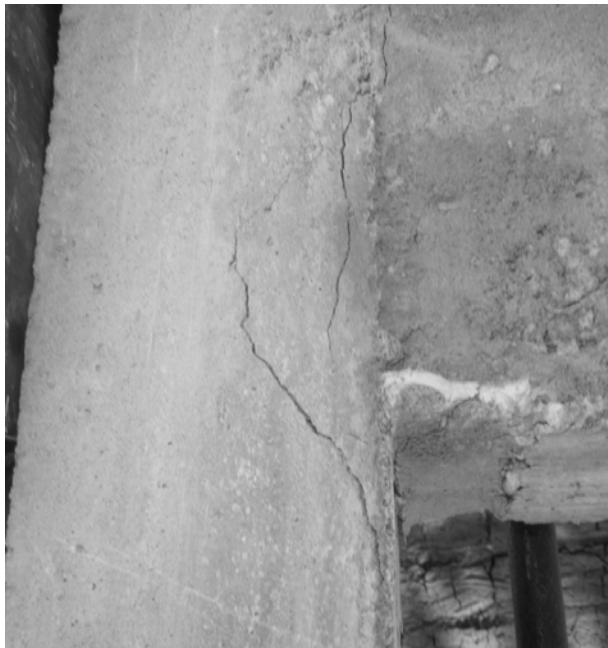
Figura 52. Fisuras en el extremo del nudo.
