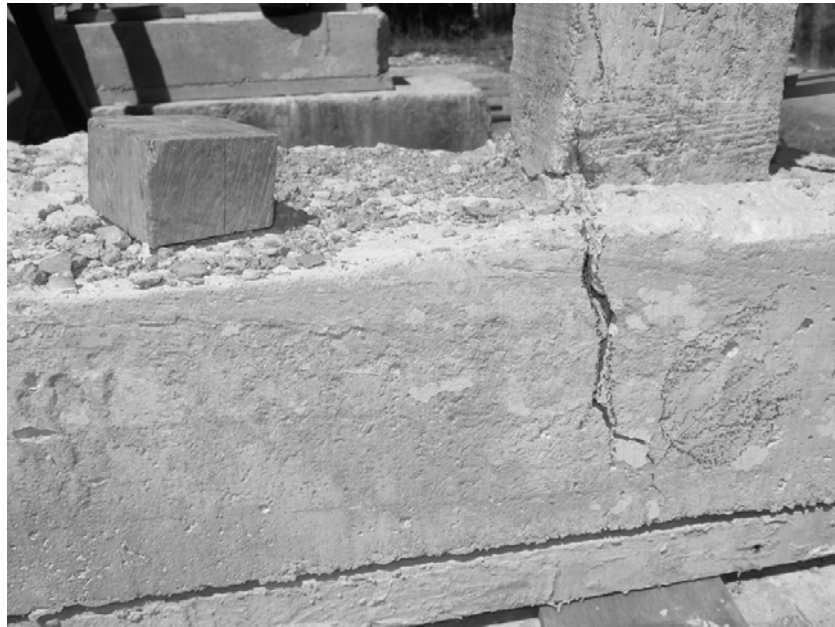
Figura 55. Fisuras en cemento.
