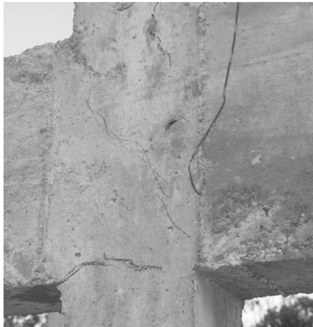
Figura 53. Fisuras en el nudo.
