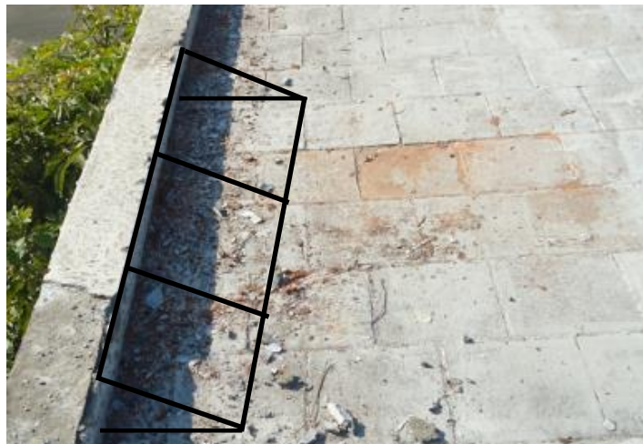
Figura 14. Pendiente en pestaña de losa
