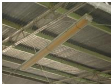
Figura 20. Lámpara fluorescente de 75 watts con difusor
