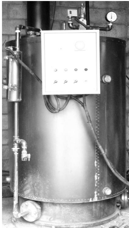
Figura 16. Caldera de biomasa
