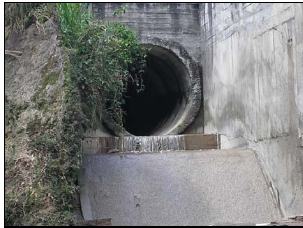
Figura 11. Descarga de colector
