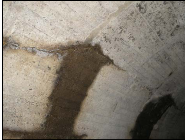
Figura 30. Infiltraciones en túnel colector
