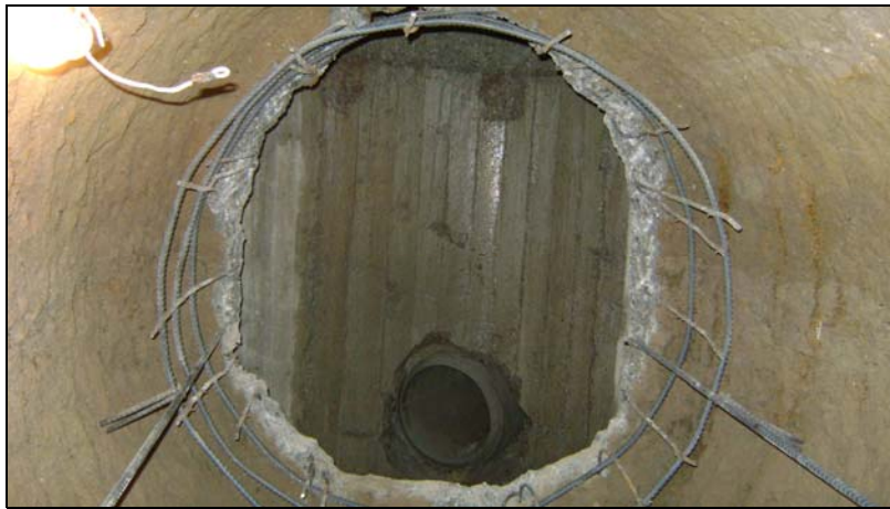
Figura 28. Infiltraciones en pozo de registro
