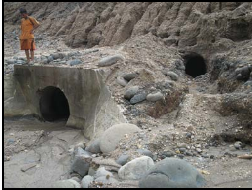
Figura 13. Degradación en cabezal de descarga
