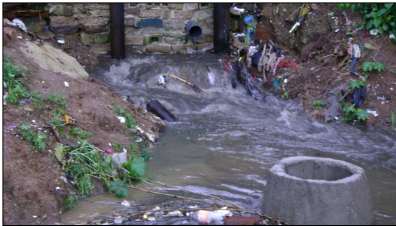
Figura 38. Inundación en registros durante una inspección de un derivador de caudal
