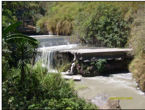
Figura 52. Vista lateral de gradas de dissipador con evidencias de erosión
