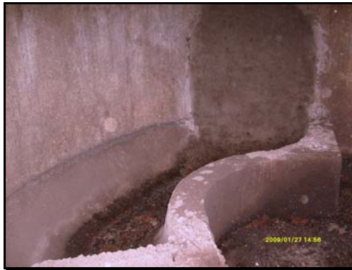
Figura 8. Derivador de caudal tipo rebalse
