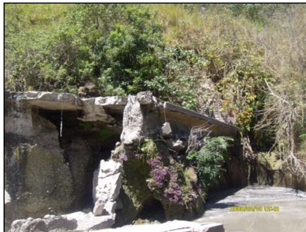
Figura 54. Oquedad en base de grada inferior de dissipador de energía
