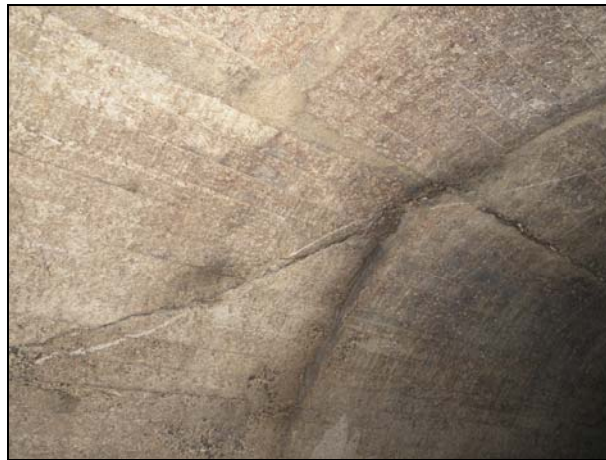
Figura 32. Asentamiento en túnel colector
