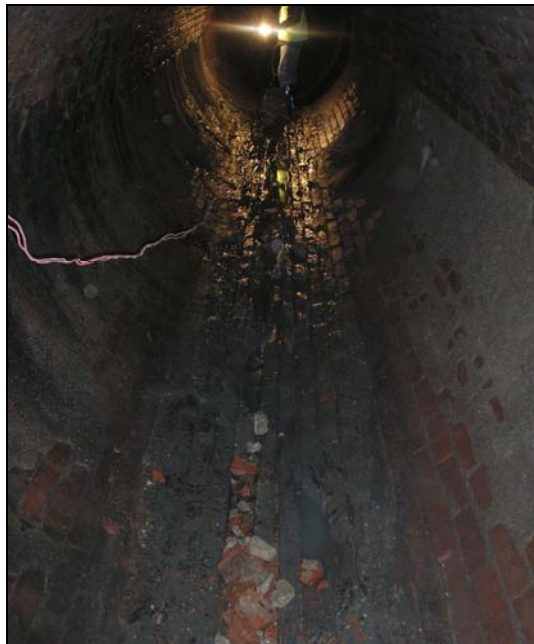
Figura 33. Desgaste en piso de colector
