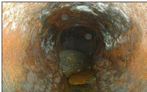
Figura 41. Asolvamiento de colector auxiliar al derivador de caudal
