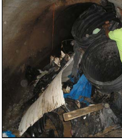
Figura 31. Obstrucciones en túnel colector
