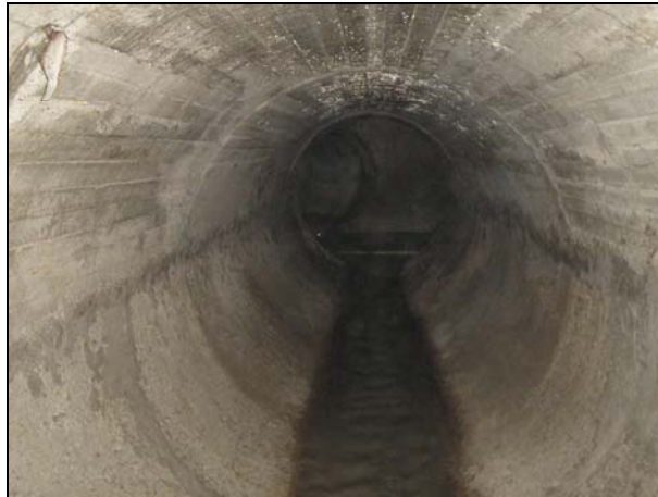
Figura 6. Cilindro de túnel colector
