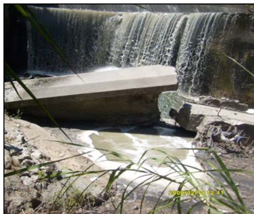
Figura 53. Falla de sección de piso por erosión en dissipador de energía
