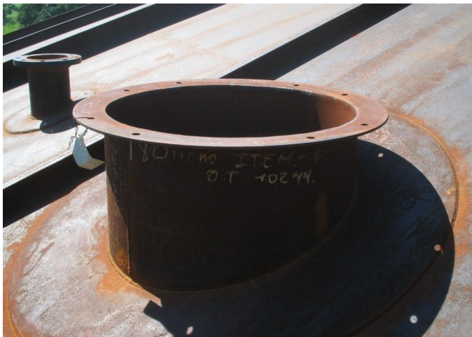
Figura 5. Paso de hombre de techo
