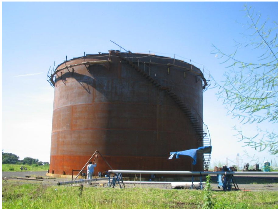
Figura 7. Escaleras de tanque atmosférico superficial
