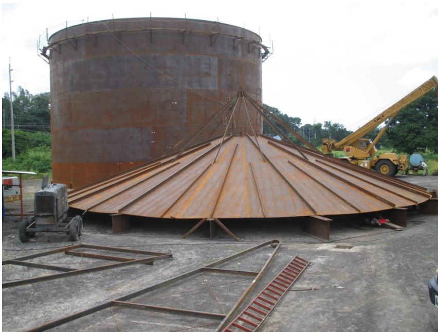
Figura 2. Tanque atmosférico cilíndrico superficial con techo tipo sombrilla
