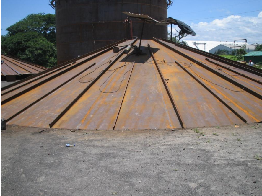
Figura 3 Techo de tanque superficial tipo sombrilla.
