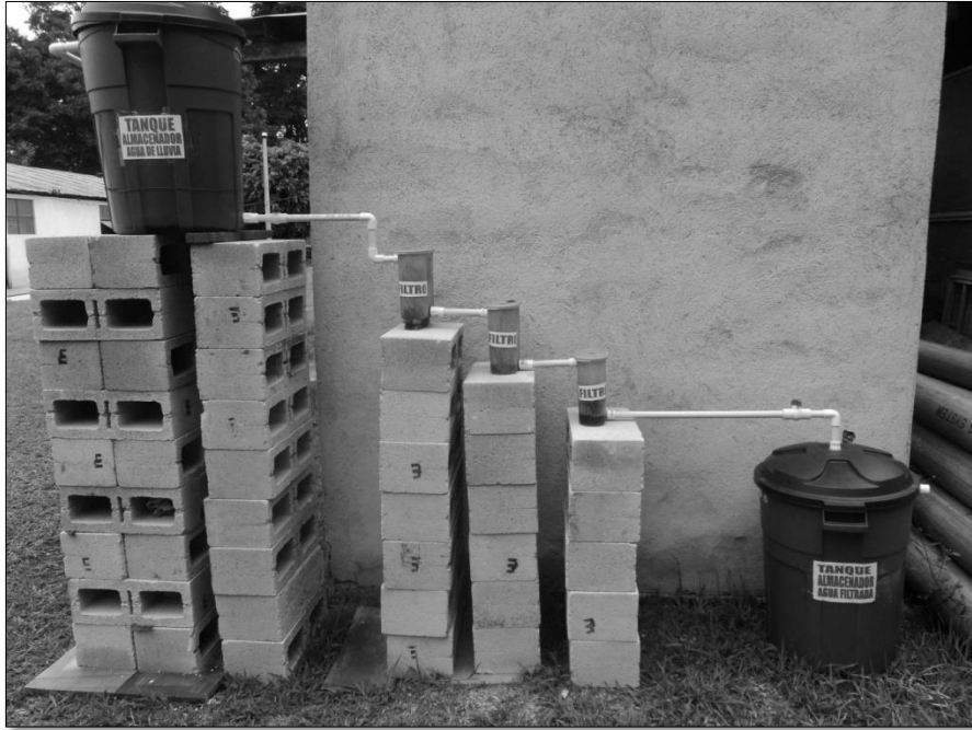
Figura 79. Sistema de filtración instalado
