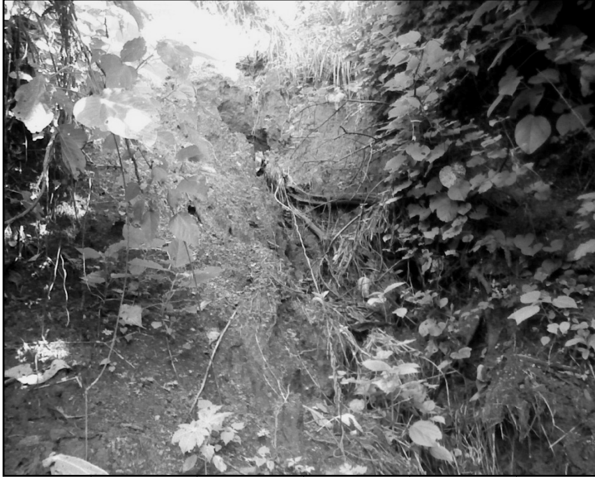
Figura 9. Talud con deslizamiento, vista desde la base
