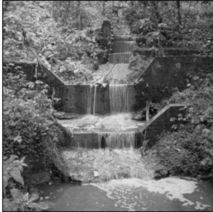
Figura 19. Ejemplo del canal de descarga
