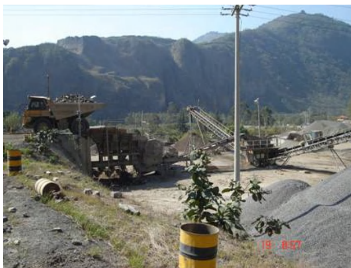
Figura 28. Proceso de transporte, trituración y conformación de diferentes diámetros de agregados, Planta Palín Oeste
