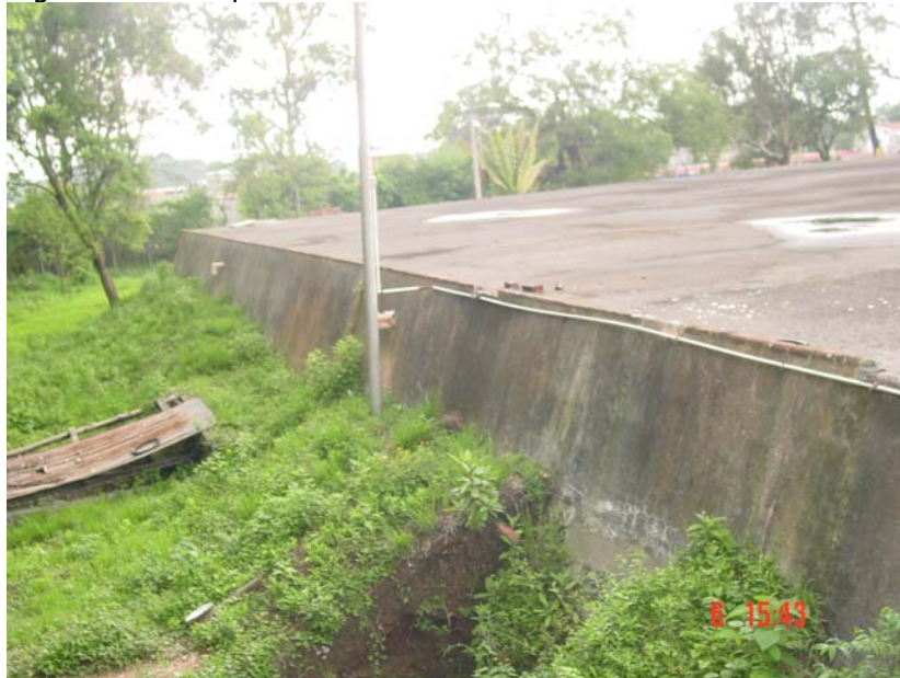
Figura 29. Tanques de distribución Acatán vista noroeste
