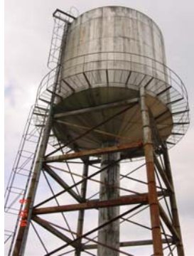
Figura 30. Tanque de distribución elevado (metálico)
