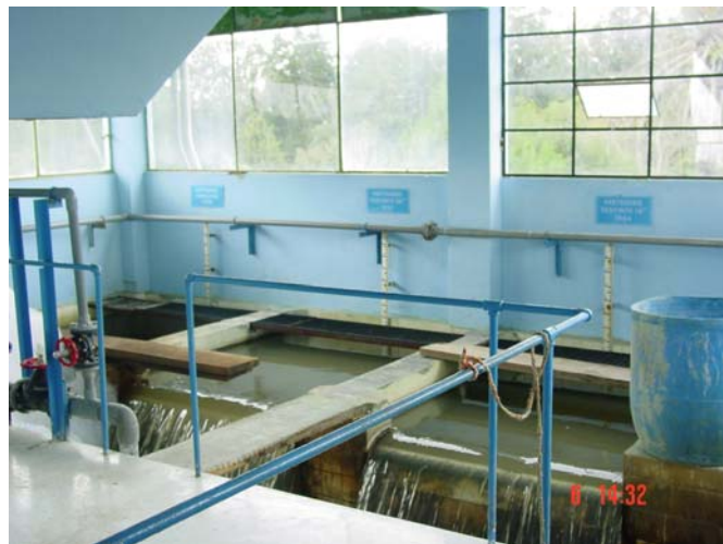
Figura 22. Vertederos de Ingreso de la Planta Santa Luisa
