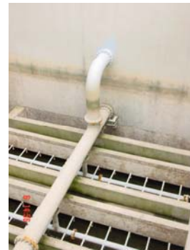
Figura 27. Base de filtros
