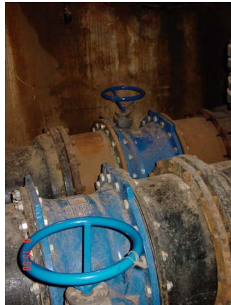
Figura 32 Compuertas de salida. Macro red de distribución
