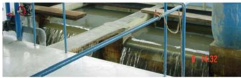
Figura 23. Canal de mezcla rápida de la planta Santa Luisa
