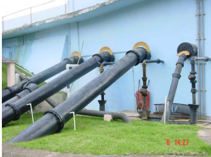
Figura 21. Ingreso tuberías de conducción a la Santa Luisa, de izquierda a derecha, Acatán, Teocinte I, Teocinte II y Canalitos.
