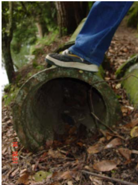
Figura 31. Estado físico de tuberías
