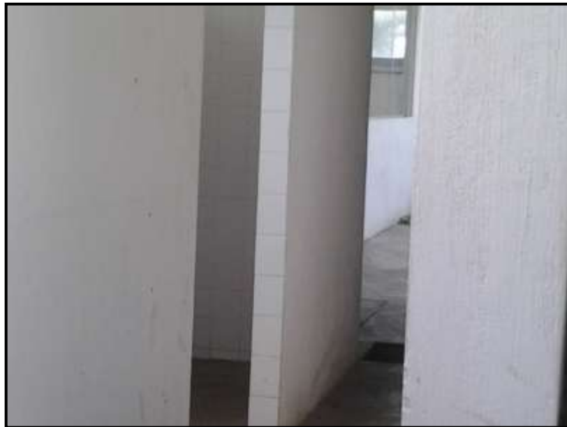
Figura 13. Situación actual de las paredes del área de cárnicos
