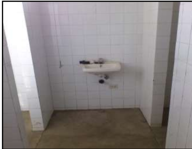
Figura 22. Situación actual de las instalaciones para lavado de manos
