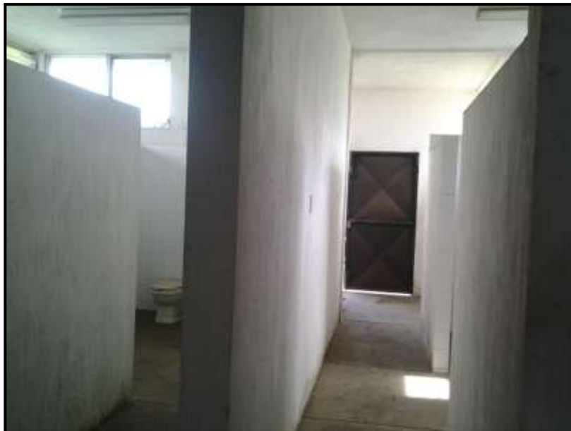
Figura 21. Instalaciones sanitarias del área de cárnicos
