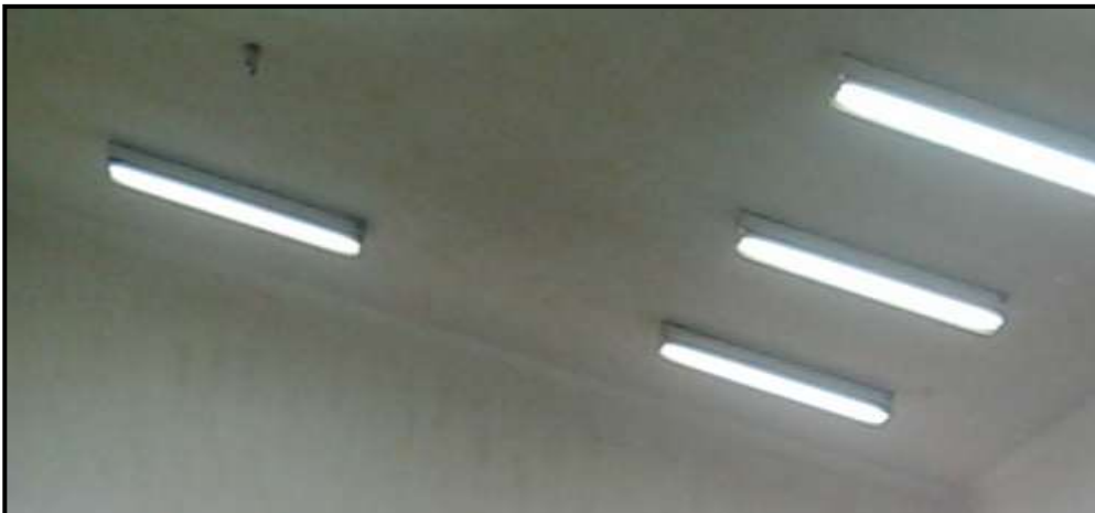
Figura 17. Situación actual de las lámparas del área de cárnicos
