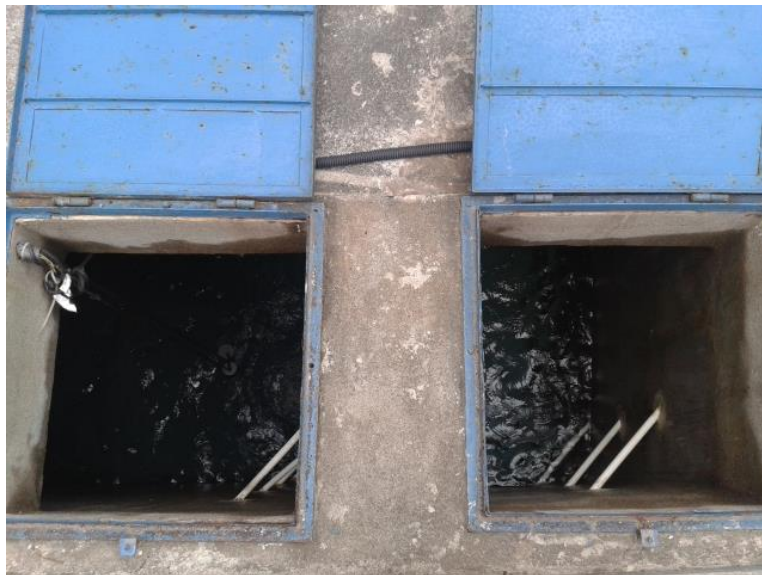
Figura 19. Tanque sumergido doble de agua potable
