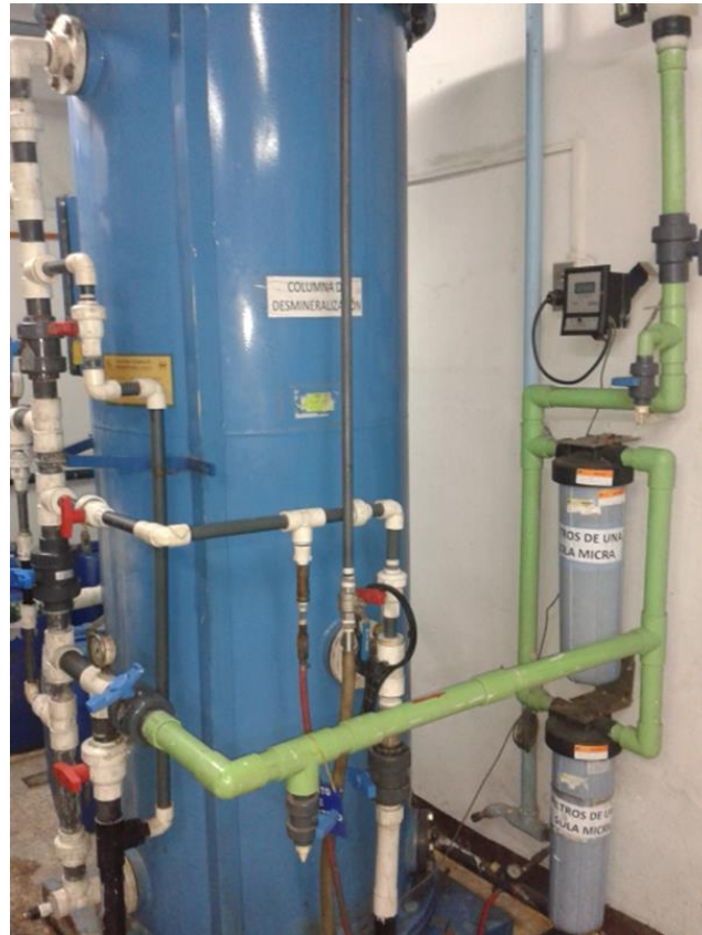
Figura 21. Cama mixta para el tratamiento de agua en proceso
