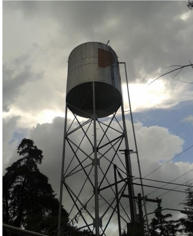
Figura 20. Tanque de agua potable
