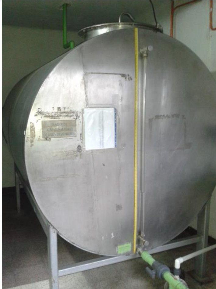
Figura 23. Tanque de agua desionizada
