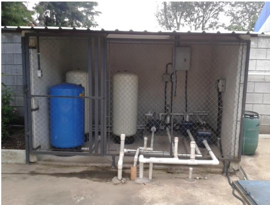
Figura 22. Cuarto de bombas
